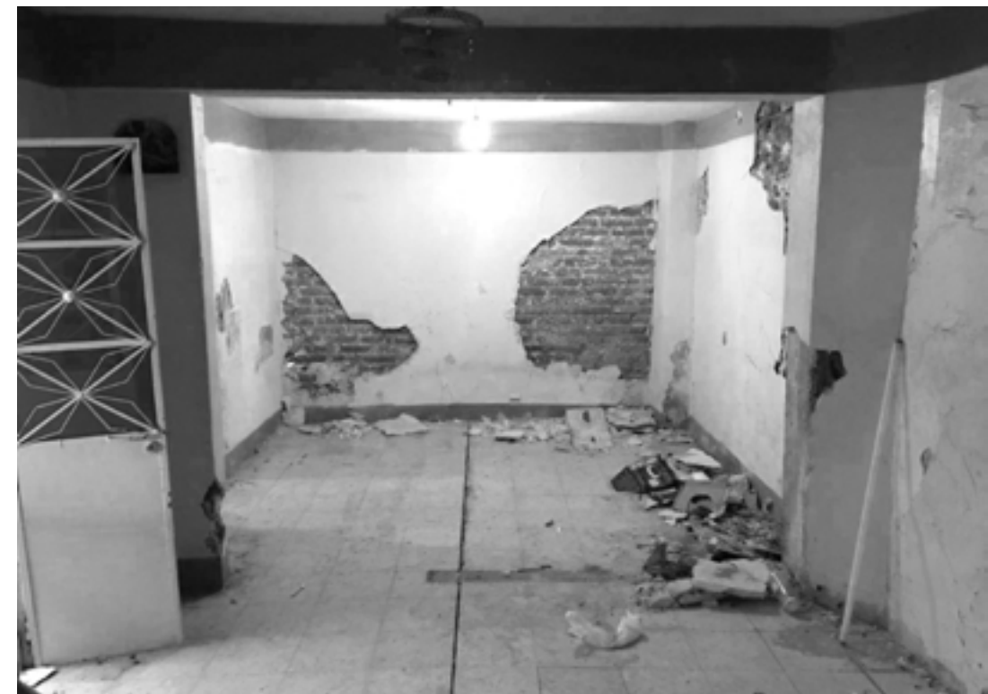
Figura 19. Daños en antigua casa. Planta baja. Foto: Oscar Torres.
