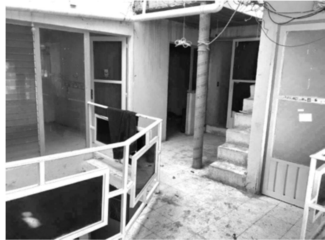
Figura 18. Daños en antigua casa. Primer nivel. Foto: Oscar Torres
