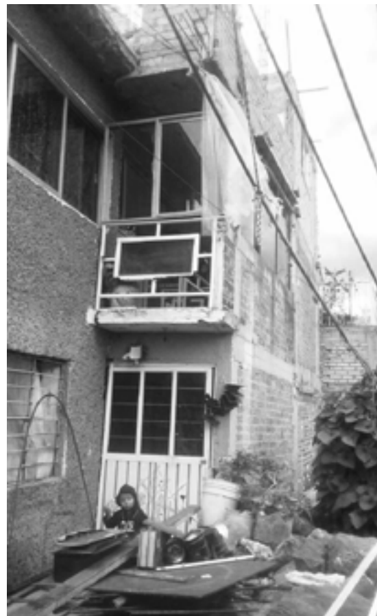
Figura 17. Daños en antigua casa. Fachada. Foto: Oscar Torres.
