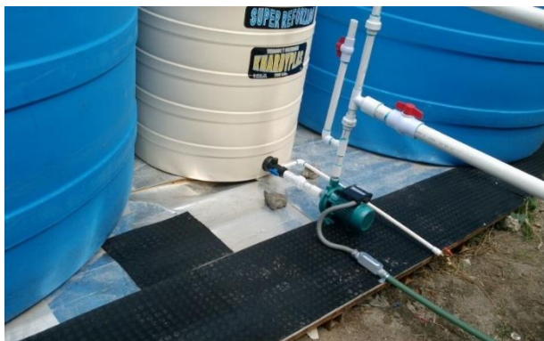
Figura 31. Sistema de bombeo
