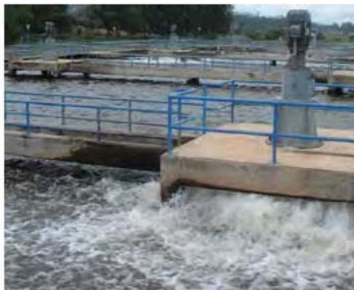
Planta de tratamiento. Foto ilustrativa.
