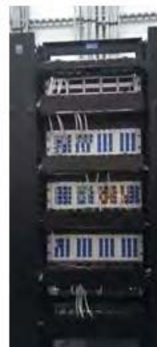
Rack localizado en el IFD. Fotografía de autoría propia.
