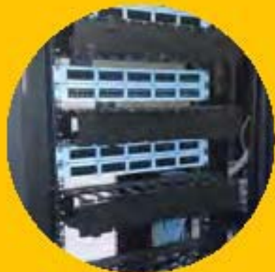
Rack y panel de parcheo. Fotografía de autoría propia.
