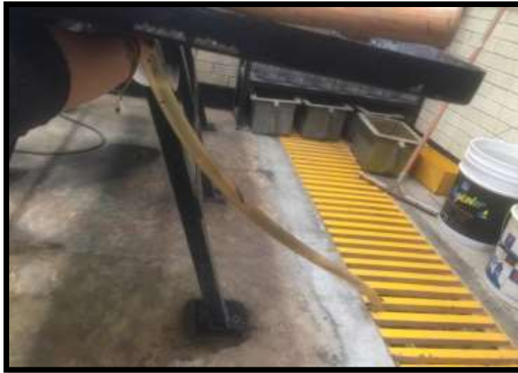
Figura 16. Salida de agua con manguera (salida original del sistema)
