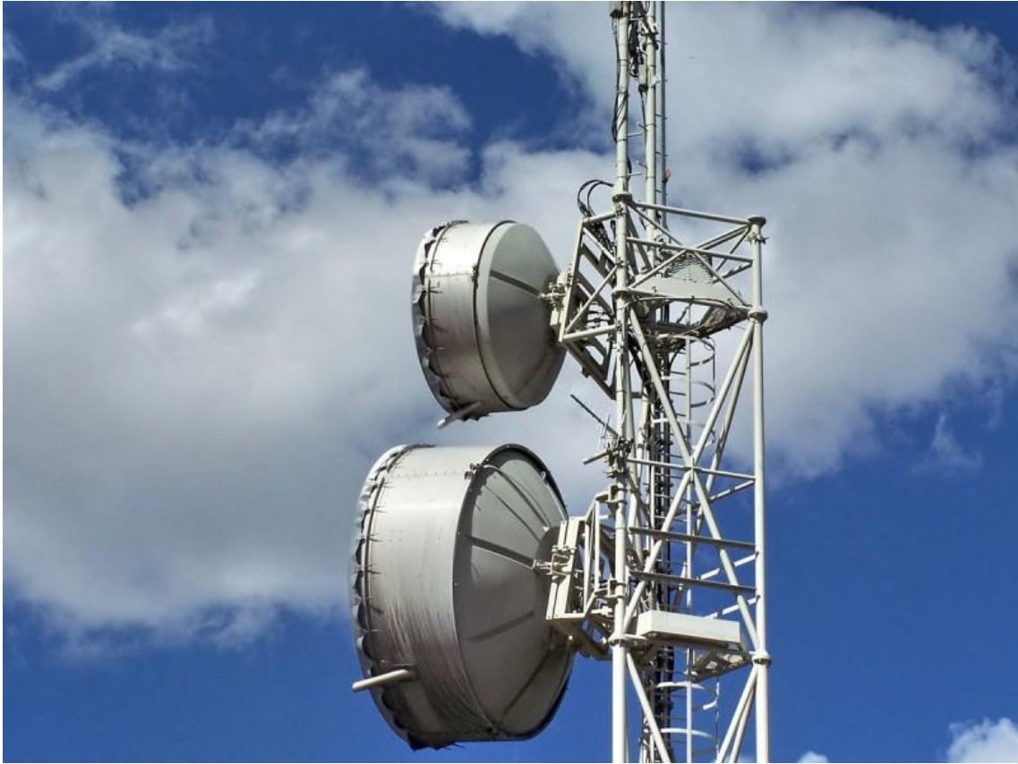
Figura 2.9. Antenas de microondas montada en torre
