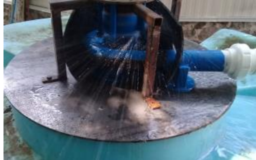
FIGURA 4.4 Fugas de agua durante la operación del banco de pruebas.
