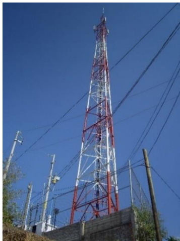
(a) Torre autosoportada con plataforma
