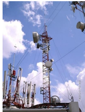
(b) Torre arriostrada con plataforma
