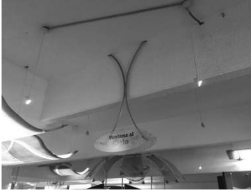
Figura 130. Techo y travesaños al interior de la sala Universo. Cabe observar que el cableado y tubería se hacen presentes a lo largo de toda la sala.
