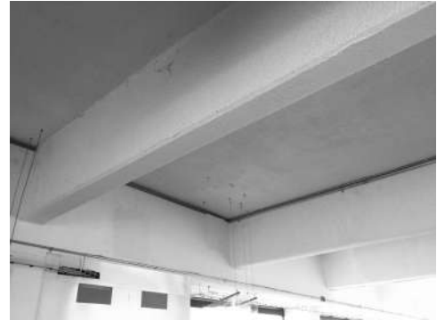
Figura 148. Traves del edificio atravesando los techos de la Sala Universo
