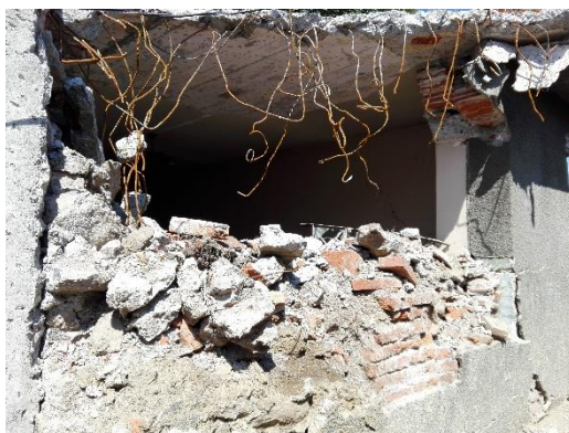
Imagen 2. Fotografía de HMAC (2017). La barda de esta vivienda colapsó casi en su totalidad
