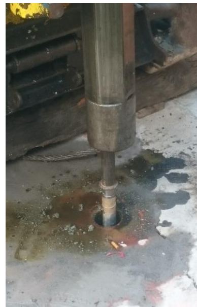
Figura 67. Inicio de la prueba, hincado del Piezocono hasta la profundidad de 8.00 m. HP Ingeniería, suelos y cimentaciones S.A. de C.V. (2017).
