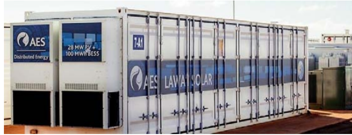
Fig. 1-2 Sistema de almacenamiento de energía en Kaua'i.
