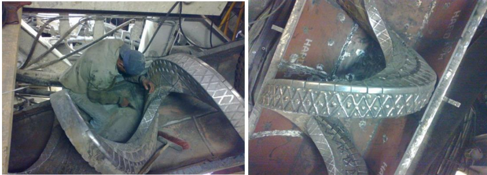
Figura 3.14 Mantenimiento por desgaste del tornillo sinfín (COMISAA,2017).
