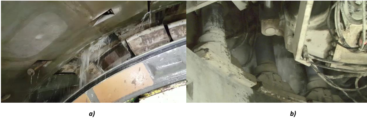
Figura 3.20 Flujo de agua hacia el interior del túnel por daños en lo cepillos; a) clave del túnel; b) cubeta del túnel.
