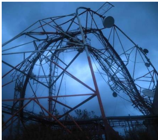
Figura 1.6. Torre de telecomunicaciones tras el paso del huracán María.
