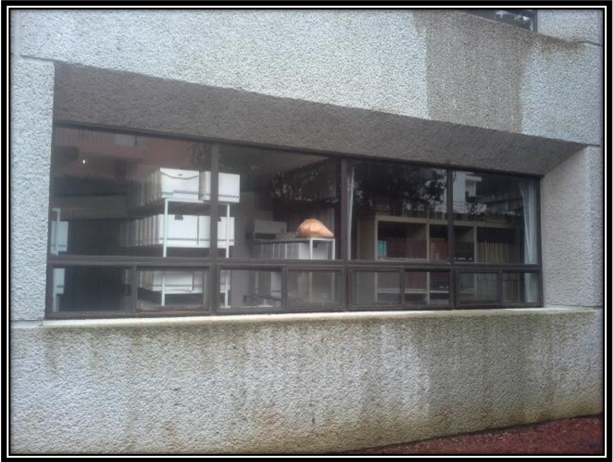
Imagen 4.22 Estantes sin espacios que no dejan cumplir la normativa. (Fuente: Propia).
