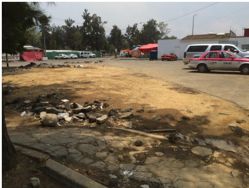
Fotografía 12. Vista de estacionamiento del mercado actual, banquetas sin man- tenimiento y en mal estado, ubicado al noreste del predio. 2018
