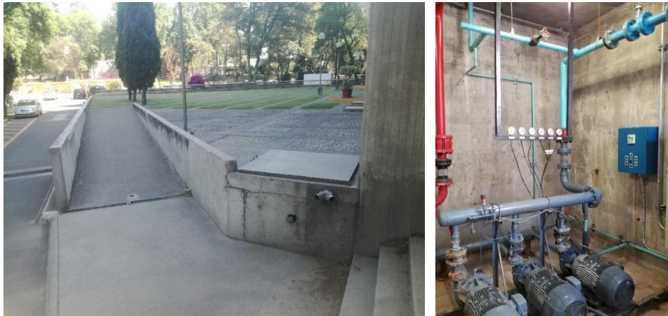
Imagen 49: Registro 3. Cuarto de bombeo. Equipos hidráulicos. Fuente propia
