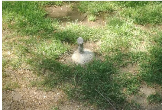
Imagen 45: Sistema de Riego en zonas exteriores, consta de Aspersores. Fuente propia.
