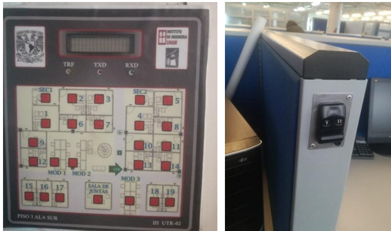
Imagen 65: Tablero de Control de Iluminación. Torre de Ingeniería N3. Control Manual de la iluminación, para controlar locales. Fuente propia.
