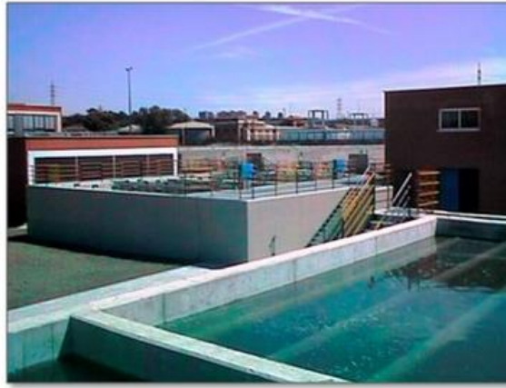
Cámara de desinfección natural. Fuente: TOPOZONO.
