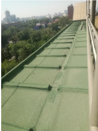
Imagen 53: Ala Poniente, uno de los extremos de donde se removieron los paneles solares. Fuente Propia.
