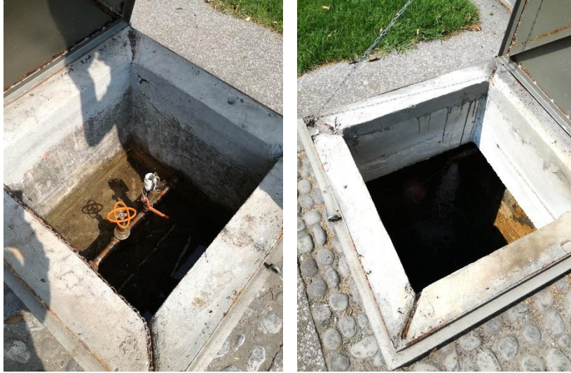
Imagen 48: Registro 1 y 2. Llave de paso y Cisterna. Fuente propia
