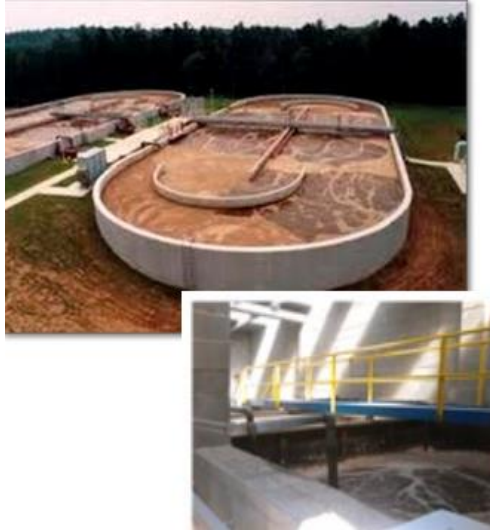
Planta de tratamiento secundaria. Fuente: TOPOZONO.
