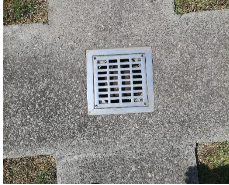
Imagen 43: Coladeras para conducción de agua al área de filtración, plazas de acceso. Fuente propia.
