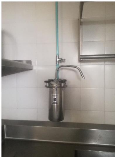
Imagen 71: Filtro potabilizador, existen 2 filtros por nivel. Fuente propia.
