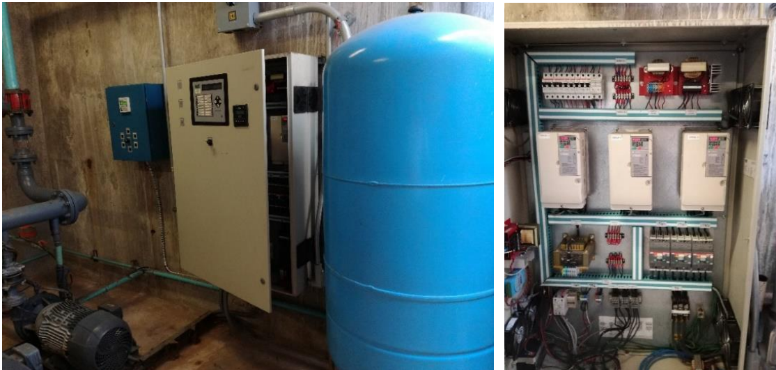
Imagen 52: Equipos de control hidráulico, Depósitos para sistema de agua y tablero de velocidad variable, agua Potable. Torre de Ingeniería, Fuente propia.
