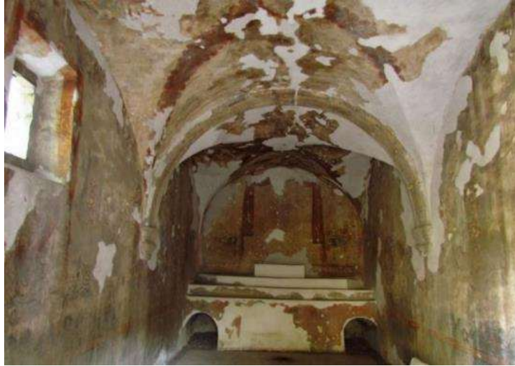
Imagen VI.4 Resanes sobre la grieta a lo largo de la bóveda de la capilla de Los Ángeles, San Miguel Ixtla; Foto BIPP, 2014, Proyecto Arte y comunidades otomíes, metamorfosis de la memoria identitaria IIE-UNAM.
