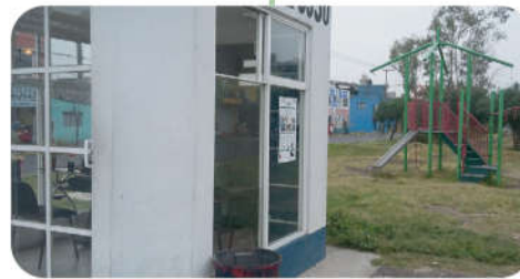
Área verde en mal estado, juego para niños en condiciones de abandono, caseta de vigilancia en buen estado, con estacionamiento mal ubicado en cabecera del camellón.
