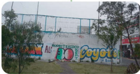
Cancha de futbol rápido en malas condiciones.
