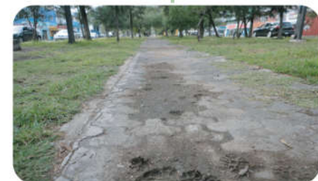
Esta sección cuenta con una mala calidad de pavimentos, el adoquín esta destruido.
