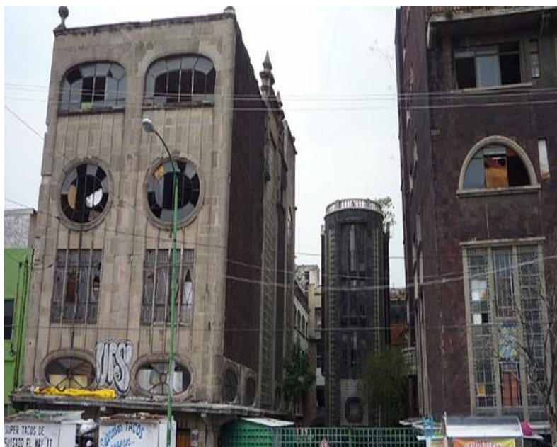
Edificios dañados por el Terremoto. Foto de autor.
