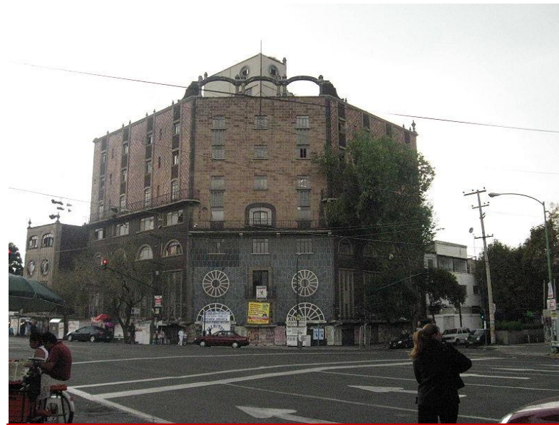
Edificios dañados por el Terremoto. Foto de autor.
