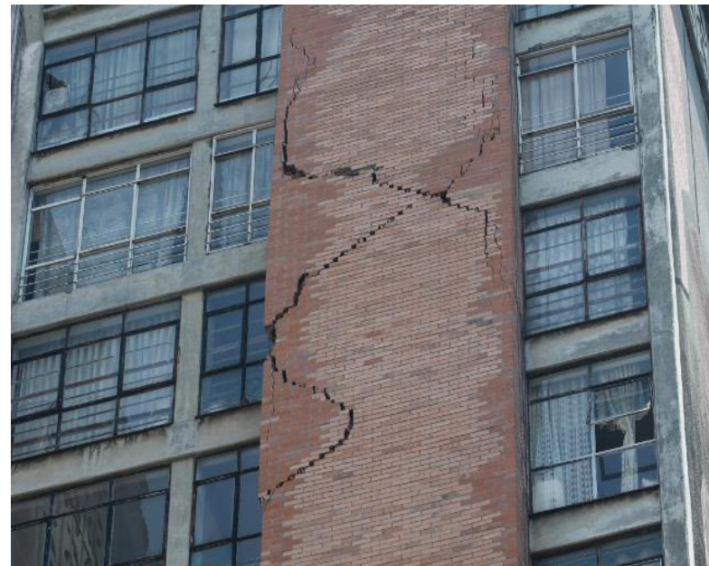
Edificios dañados por el Terremoto. Fuente. Excélsior.
