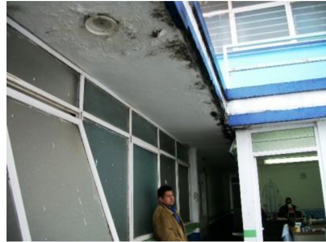
Condiciones de las instalaciones del Centro de Salud de Uruapan Michoacán.
