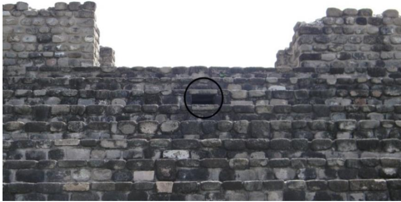
Figura A.28. Salida del desagüe proveniente del patio de la Pirámide de las Estelas (G8), sobre la escalinata principal de la estructura.
