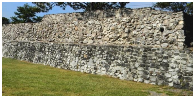
Figura A.2. Detalle del muro de recubrimiento de rocas andesitas estucadas, sobre el muro estructural de rocas calizas sin trabajar.
