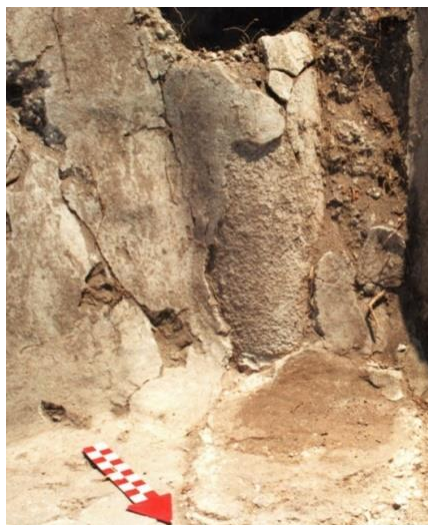
Figura A.27. Drenaje en muro de cuarto (González C., et al. 1993-1994:Figura 30).
