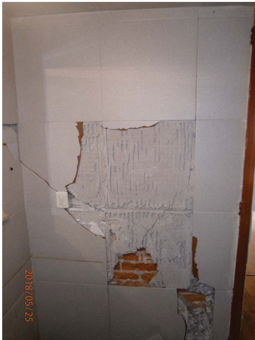
Figura 2.20: Azulejo desprendido por fisura diagonal por fuerza cortante en el baño del departamento.
