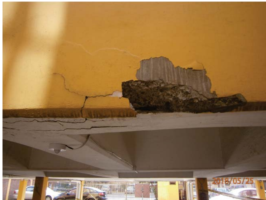
Figura 2.17: Daño en nervadura principal del sistema de piso.
