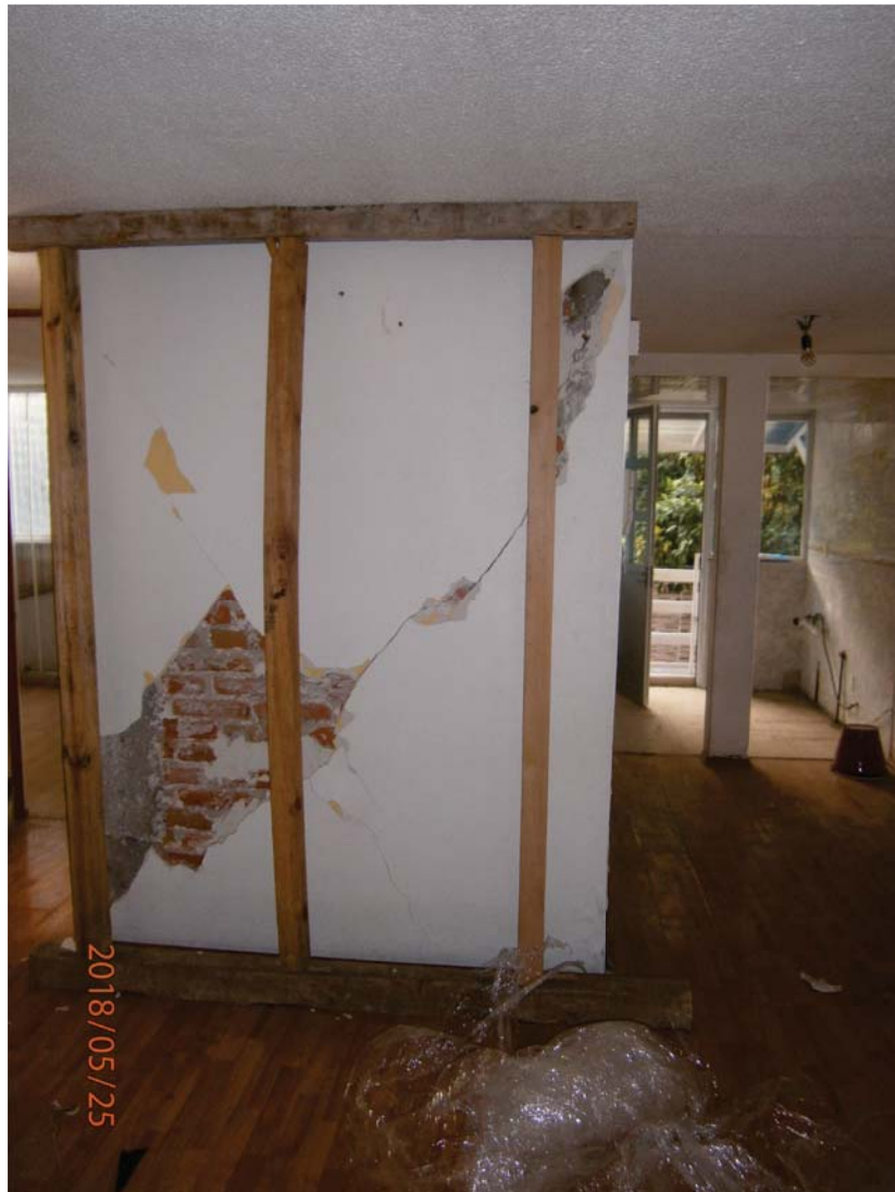
Figura 2.18: Daño en muro de mampostería, fisura diagonal por fuerza cortante.
