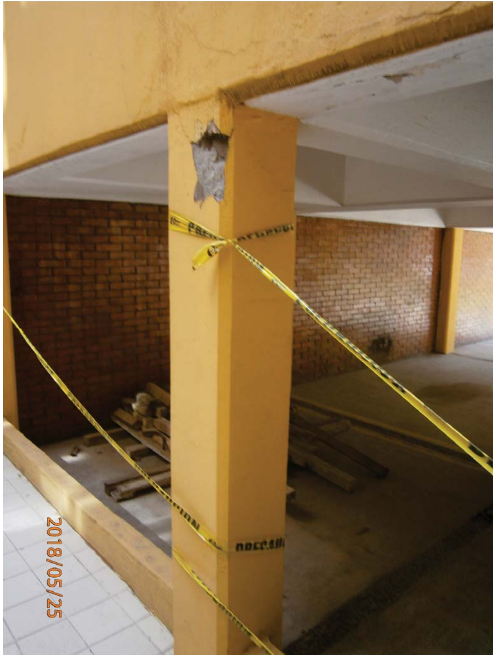
Figura 2.19: Daño grado II [25] en ciertas columnas de planta baja del edificio.
