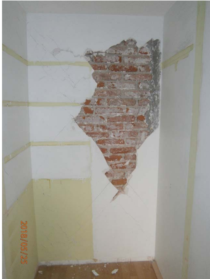
Figura 2.21: Desprendimiento de yeso, pintura y recubrimiento de los muros.
