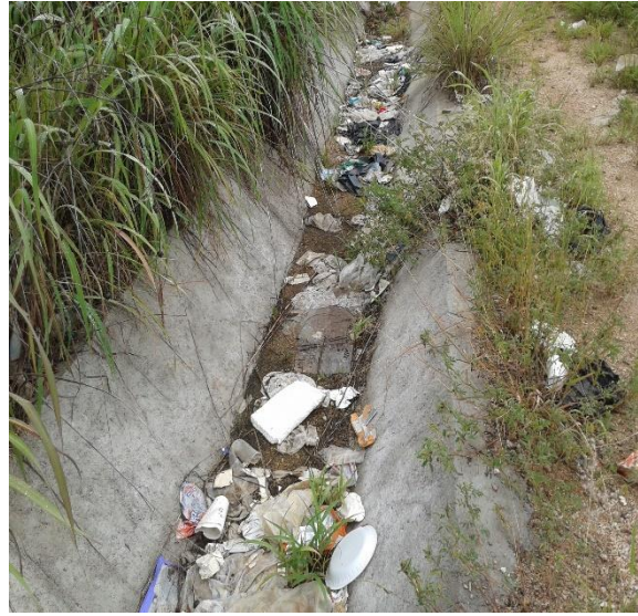
b) Canales de desagüe con RSU.
