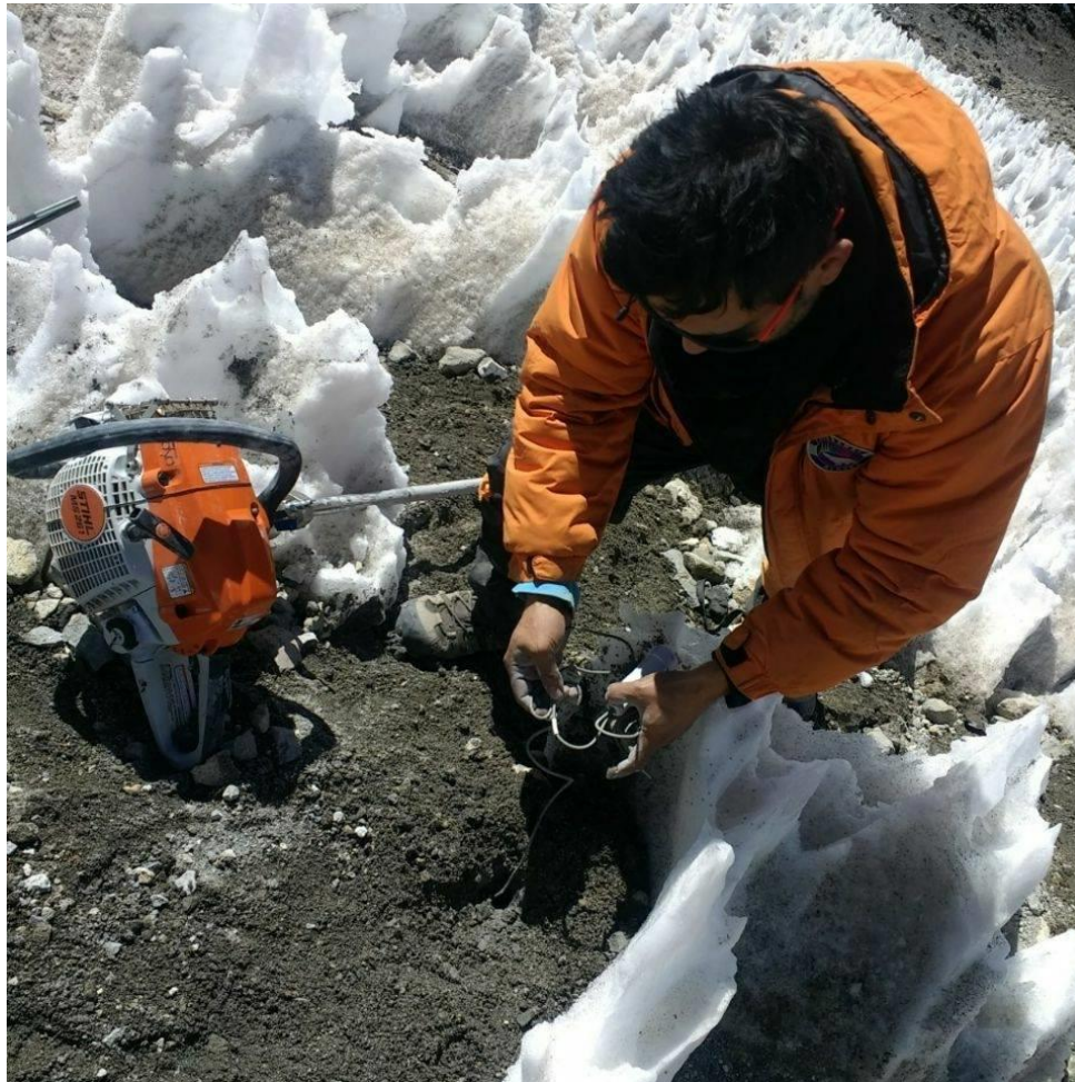
Figura 74. Instalación de sensores a 5,330 m snm, ladera sur, para análisis futuros.
