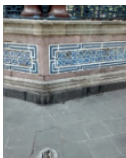
Contaminación visual Fuente: Autoría propia
