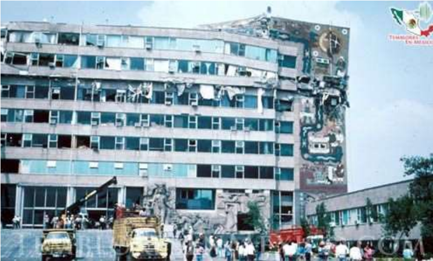
Imagen 2.04. Sismo del 19 de septiembre de 1985, ciudad de México. Edificio de la Secretaría de Comunicaciones y Transportes.
