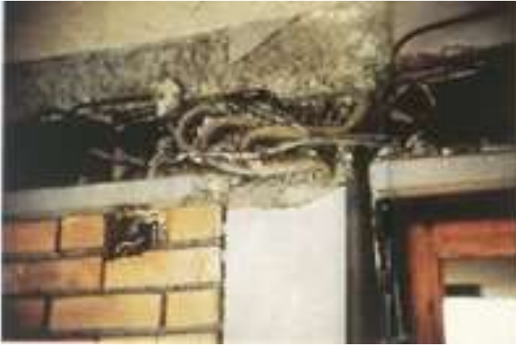
Imagen 2.02. Edificación dañada por efecto de columna corta, (Popayan, Colombia,1983)
