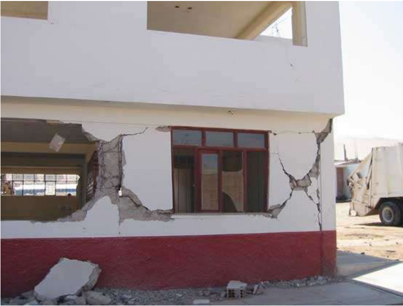
Imagen 2.01. En esta imagen se muestran los daños causados por el efecto de columna corta tras un sismo. Se puede observar la configuración típica (columnas con muros intermedios).
