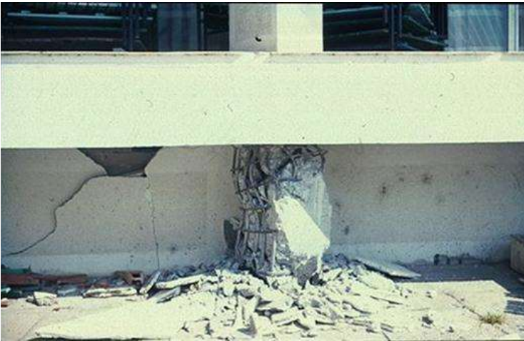
Imagen 2.03. Falla de una columna corta en el Hotel Korali, durante el sismo de Montenegro ,1979.
