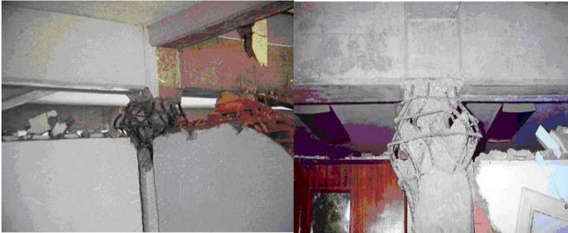
Imagen 2.08. Edificio habitacional con daños en las columnas cortas durante el sismo de 1996 en Chile. Se observa claramente la configuración estructural que predispone a la edificación a presentar este tipo de daño.
