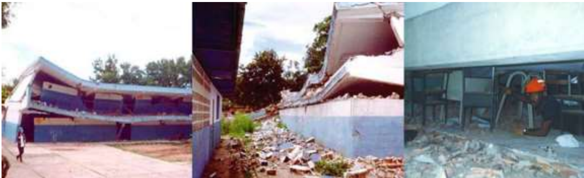
Imagen 2.09. Daños en edificio escolar (Liceo Raimundo Martínez Centeno) durante el sismo de 1997 en Venezuela. Murieron 33 personas a causa de la falla de este edificio.
