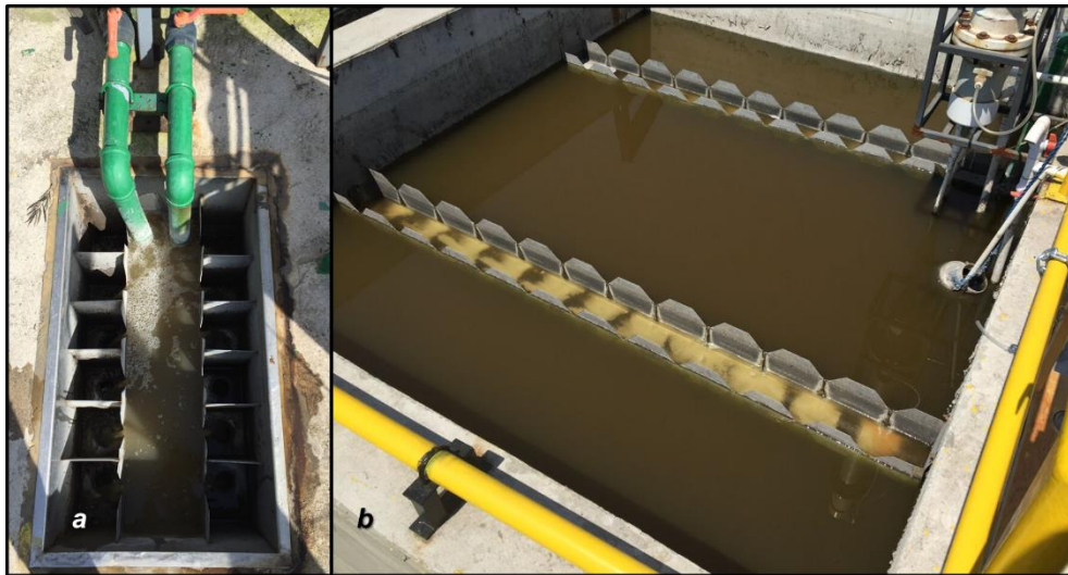
Figura 4.1. Fotografía de la caja de repartición de influente (a) y parte superior de reactor UASB (b) de la PTAR de la FCPyS.
