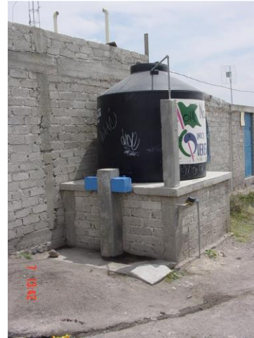
Hidrante con medidor
