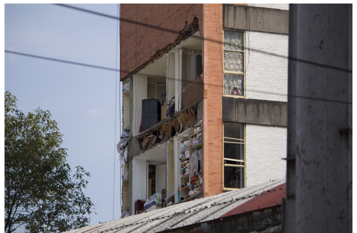
Edificio de viviendas dañado durante sismo 19-sep-17.
