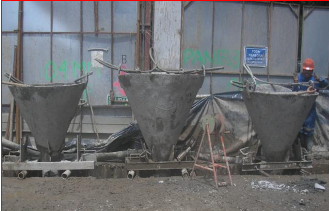
Figura 120. Colocación de tolvas para colado de muro Milán; Autor: Ing. Francisco Israel Callejas Quezada. (CIMESA 2011).
