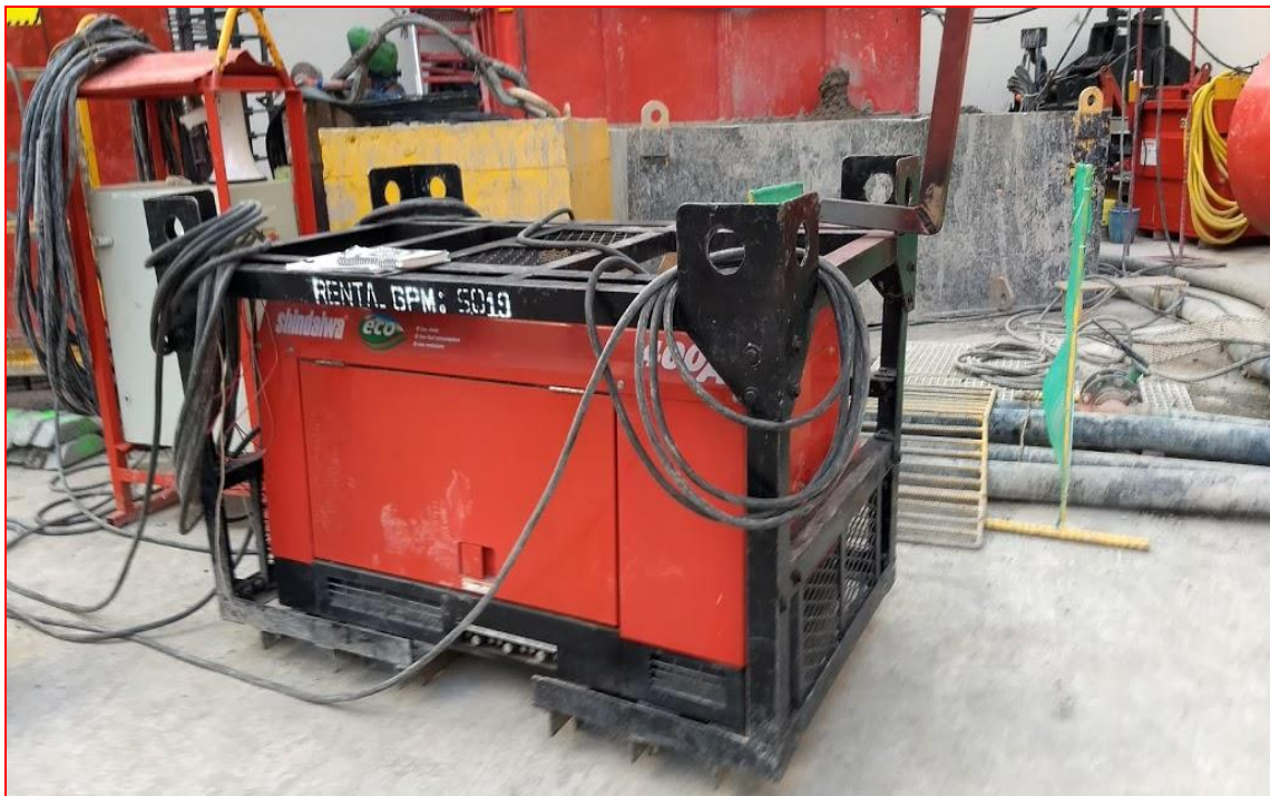
Figura 62. Planta soldadora presente en el predio. (CIMESA 2019).
