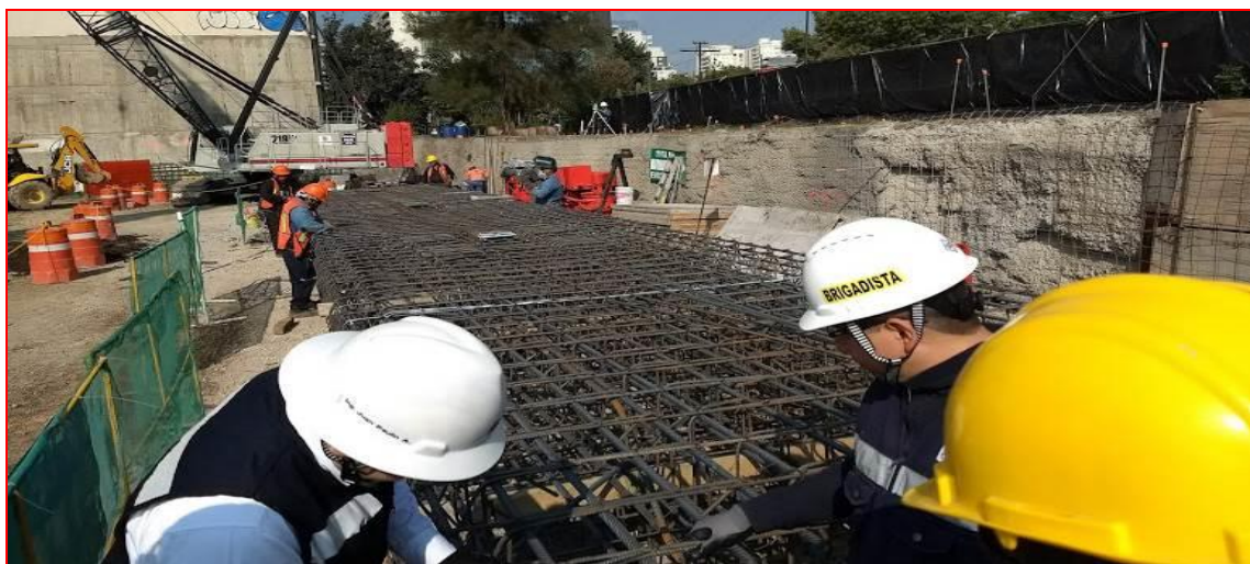
Figura 100. Revisión y verificación del armado de muro Milán; proyecto "MARNHOS, Lago Filt 7". (CIMESA 2018).
