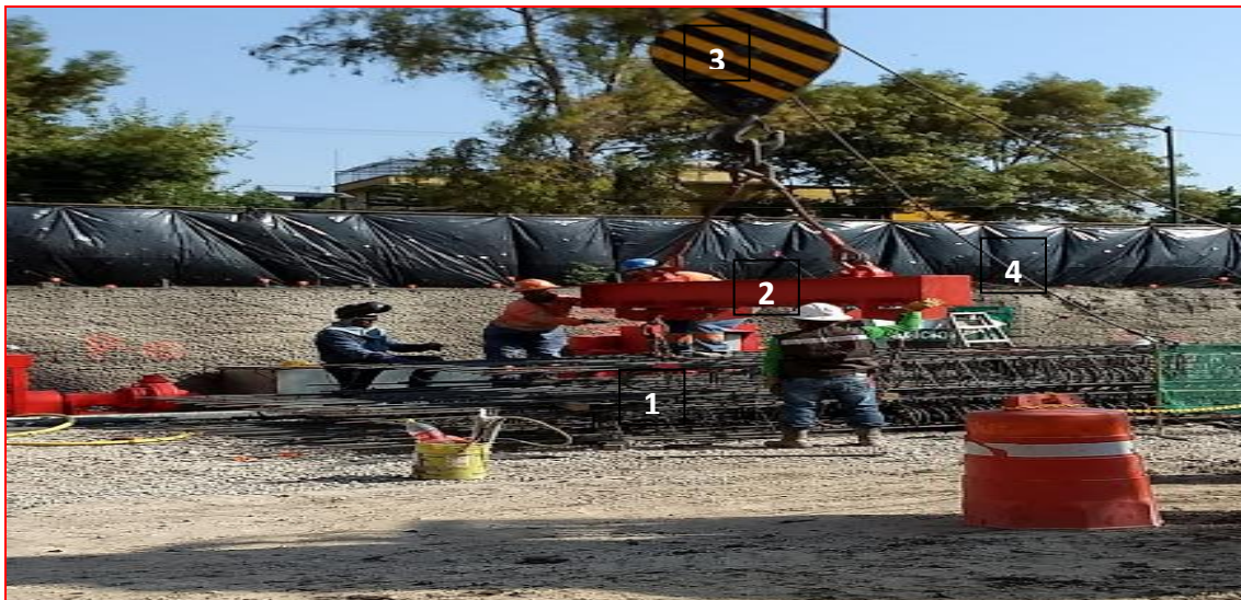
Figura 102. Maniobras para el izaje del armado de muro Milán; proyecto "MARNHOS, Lago Filt 7". (CIMESA 2018).
