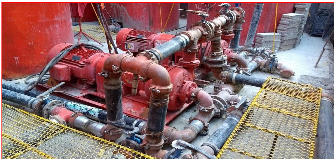
Figura 76. Elementos necesarios para el funcionamiento de la central de lodos: bombas, tuberías, codos, mangueras, etc. (CIMESA 2019).
