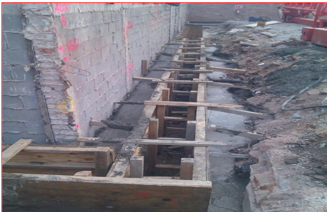
Figura 73. Zanja para alojamiento, previo a colado de brocal; Autor: Ing. Francisco Israel Callejas Quezada. (CIMESA 2011).
