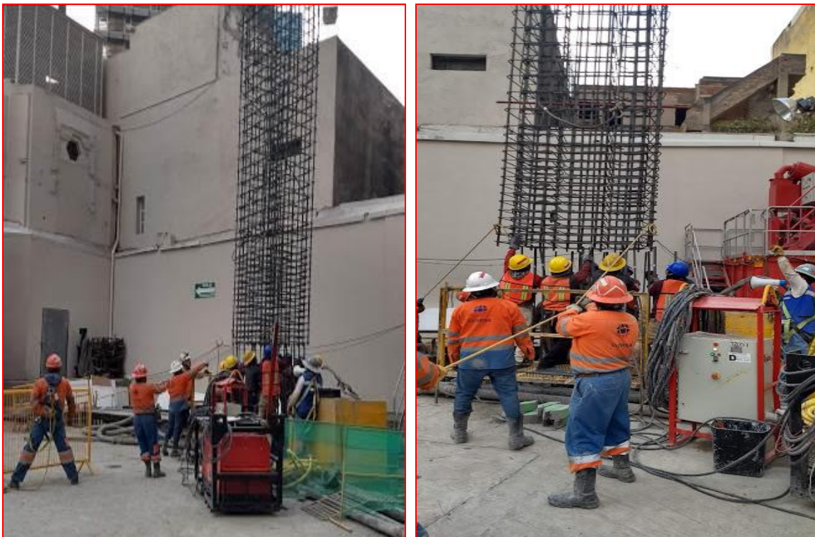
Figura 110 y 111. Maniobras para colocación del armado de muro Milán dentro de la lumbrera en el sitio de obra. (CIMESA 2019).
