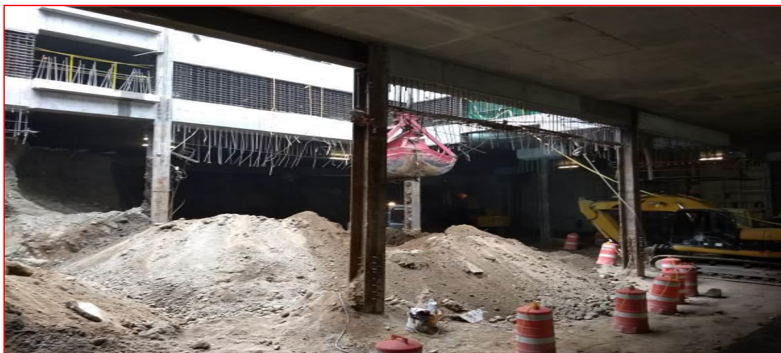
Figura 17. Ejecución de obra con método Top-Down; proyecto "MIRA, Río San Joaquín 498". (CIMESA, 2018).
