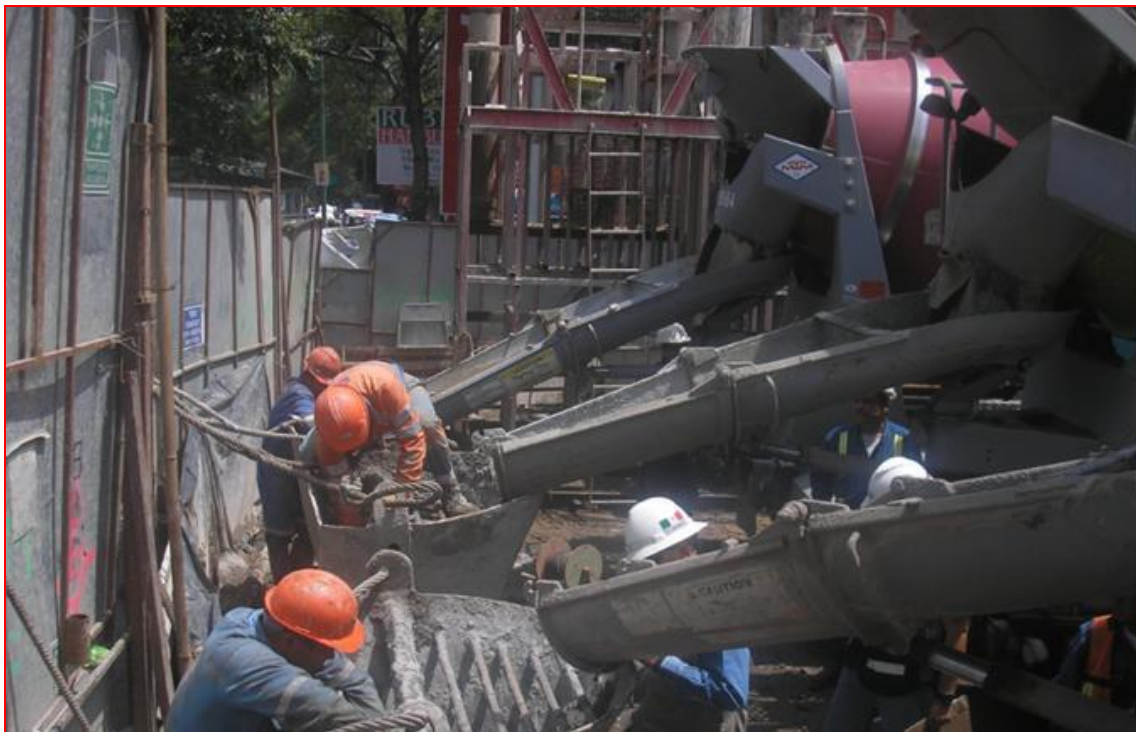
Figura 121. Ejecución programada de colado de muro Milán; Autor: Ing. Francisco Israel Callejas Quezada. (CIMESA 2011).
