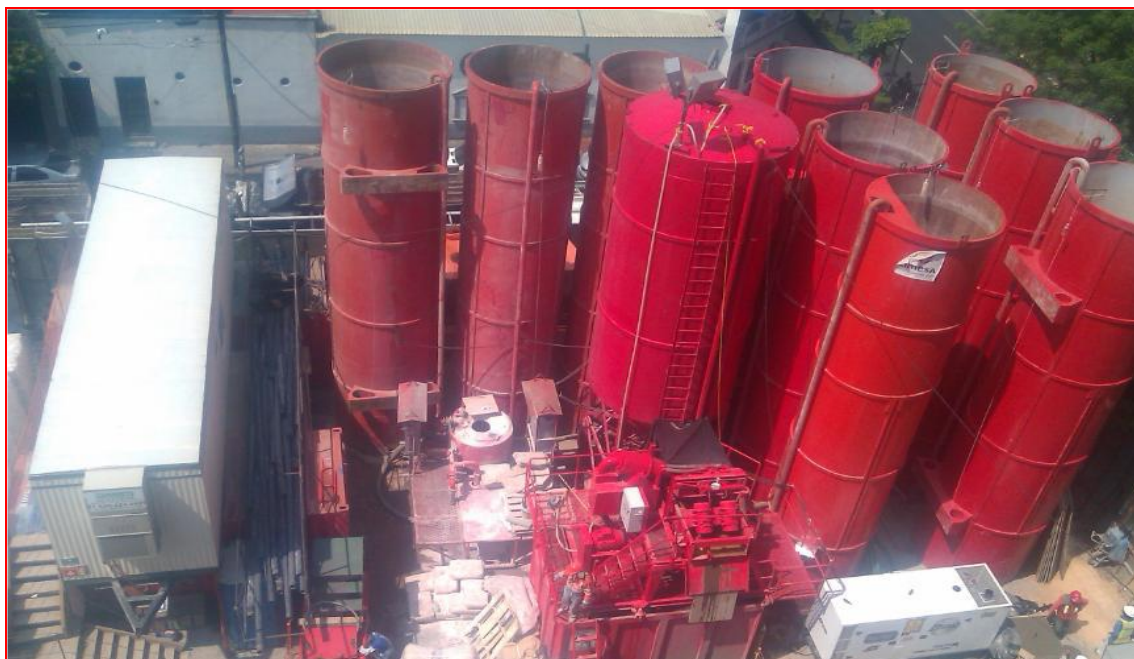
Figura 74. Central de lodos de perforación, conformada por silos, desarenador, digestor, generador de energía, tarimas con bentonita; Autor: Ing. Francisco Israel Callejas Quezada. (CIMESA 2011).
