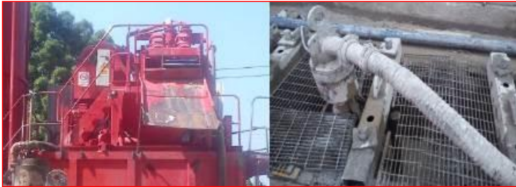
Figura 70. Detalle de desarenador tipo Caviem y tubería de extracción de lodo para desarenado; proyecto "Reforma 509", (CIMESA 2014).
