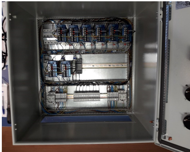
Figura 3.35 Una segunda vista de la plancha dentro del cuadro eléctrico.
