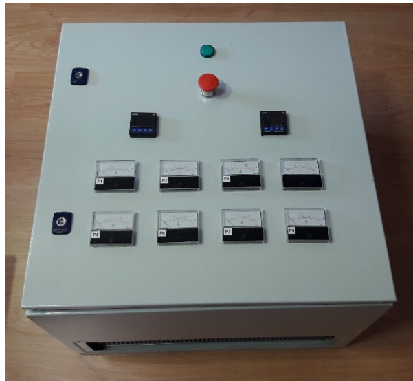
Figura 3.29 Montaje de componentes en el panel (Puerta cerrada).
