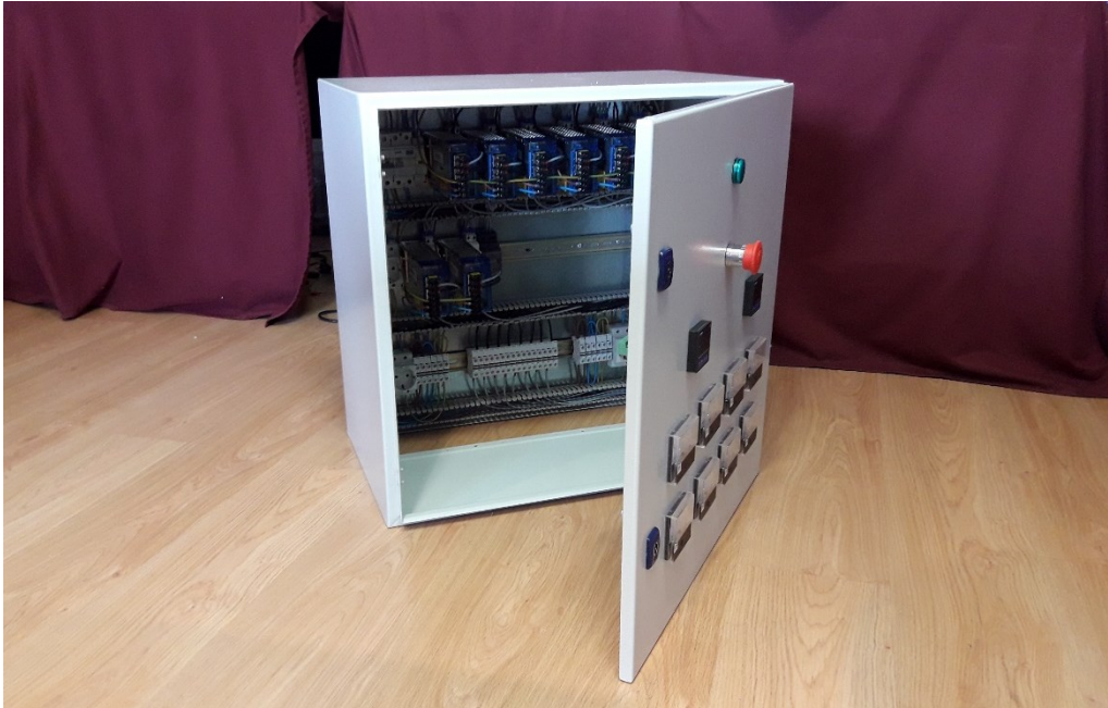
Figura 3.38 Sistema de alimentación terminado, dentro del cuadro eléctrico.
