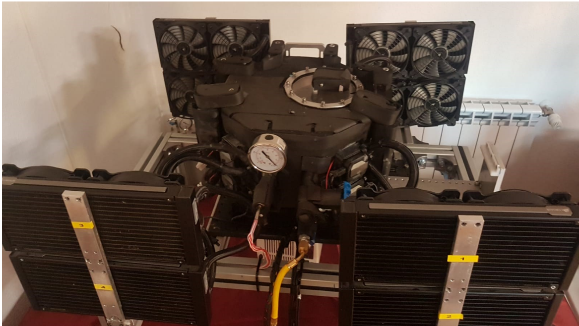
Figura 4.7 Vista 2 de la cámara climática ordenada.
