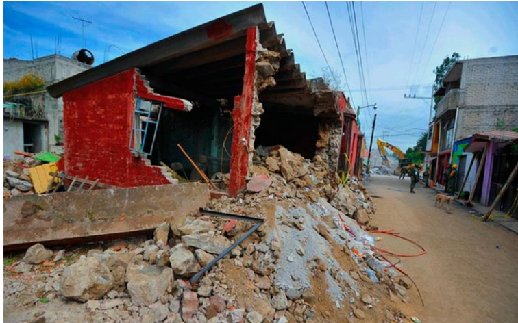
Ilustración 7. Viviendas colapsadas en San Gregorio
