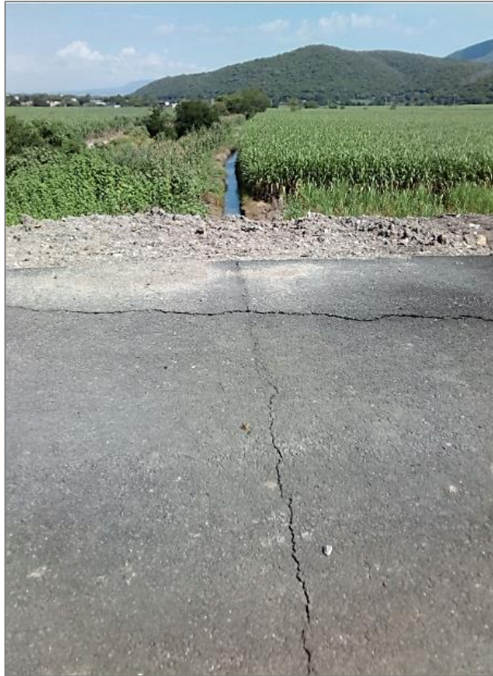
Figura 2.7 – Grietas longitudinales y grietas de resiliencia , Fotografía, Autopista Siglo XXI, 2017.
