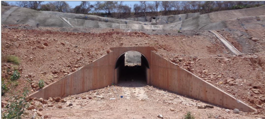
Figura 4.7 - Aleros en salida de obra de drenaje tipo bóveda, Fotografía, Autopista Siglo XXI, 2017
