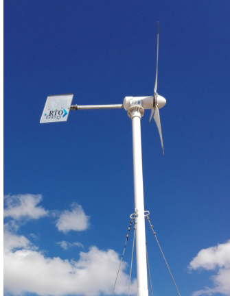
Figura 3-6. Aerogenerador de 1 kW marca RTO Energy.
