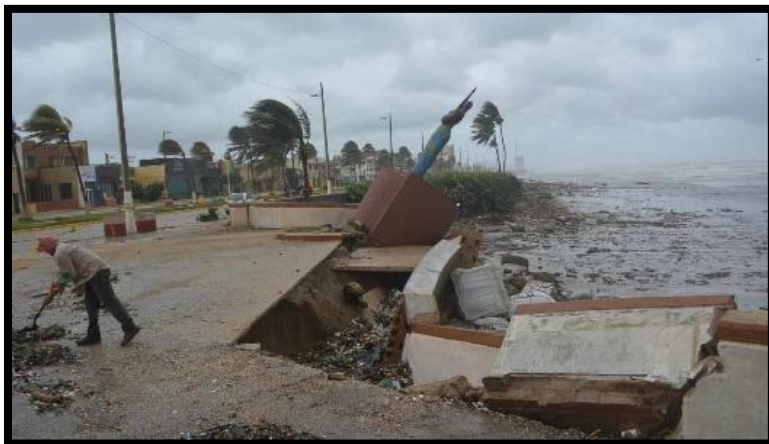
Figura 27. Infraestructura del malecón costero colapsada, nov. 2018.
