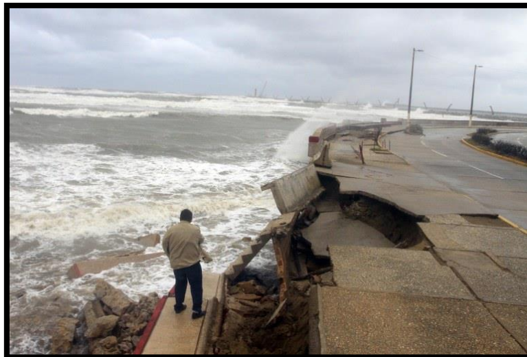
Figura 23. Infraestructura del malecón costero destruida.
