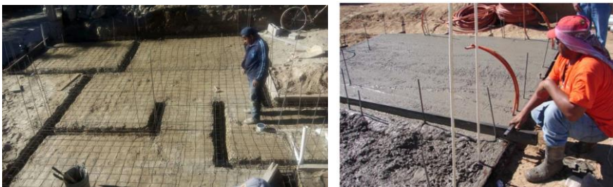
Foto 21, colocación de acero de refuerzo en la cimentación y vaciado de losa. Fuente: Propia
