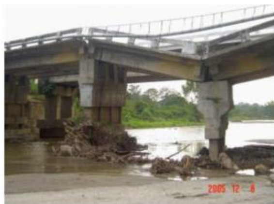
Figura 2.3 Daño en la superestructura del puente Tepuzapa por asentamiento de uno de sus apoyos (Rivera et al., 2006)
