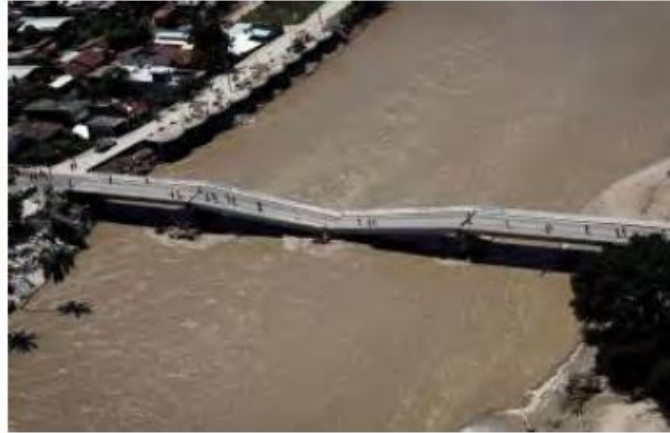
Figura 2.5 Colapso de la estructura del puente Coyuca Benítez ( www.eluniversal.com.mx )
