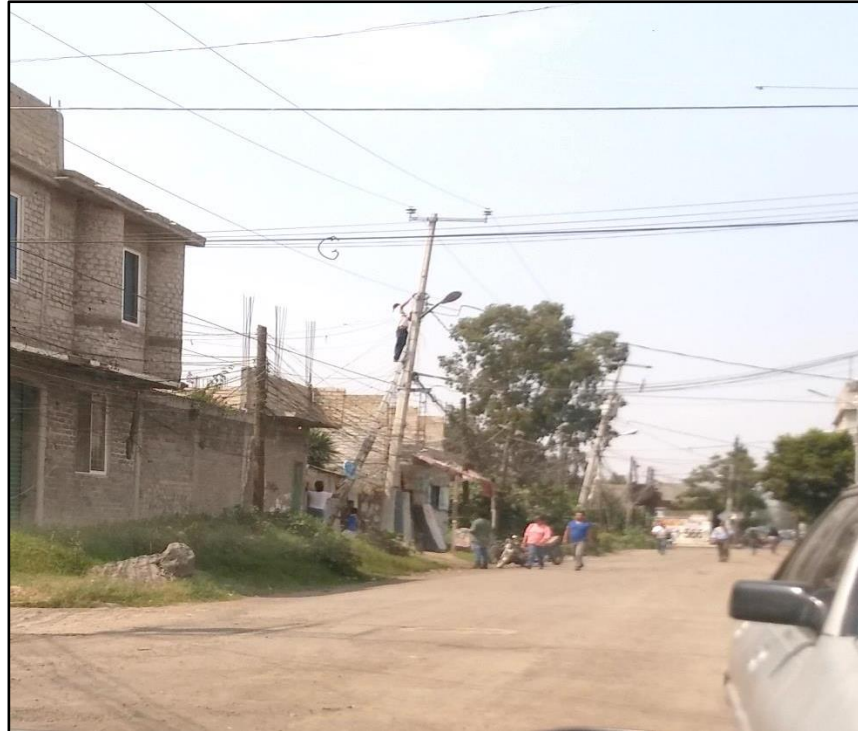
Fuente: Sandra Hidalgo. Asentamiento irregular "Ampliación La Conchita". Instalación de servicio provisional de luz por residentes del asentamiento.
