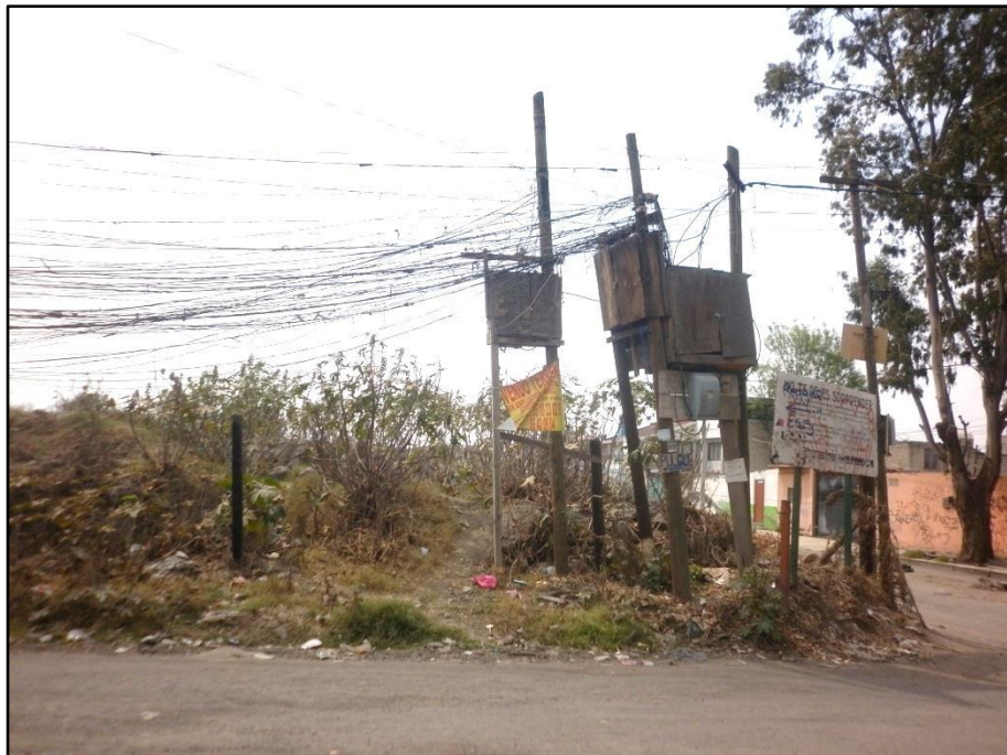
Fuente: Sandra Hidalgo. Asentamiento irregular “Ampliación La Conchita”. Cajas eléctricas provisionales para abastecer al asentamiento. Cada calle que colinda con Colonia la Conchita cuenta con su propia caja para proveer de electricidad a toda la calle .
