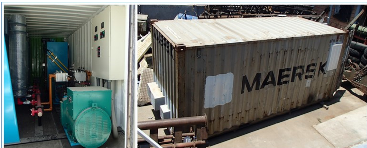
Figura 35.- Sistema de conversión y generación de energía del WEC DINA-EF
