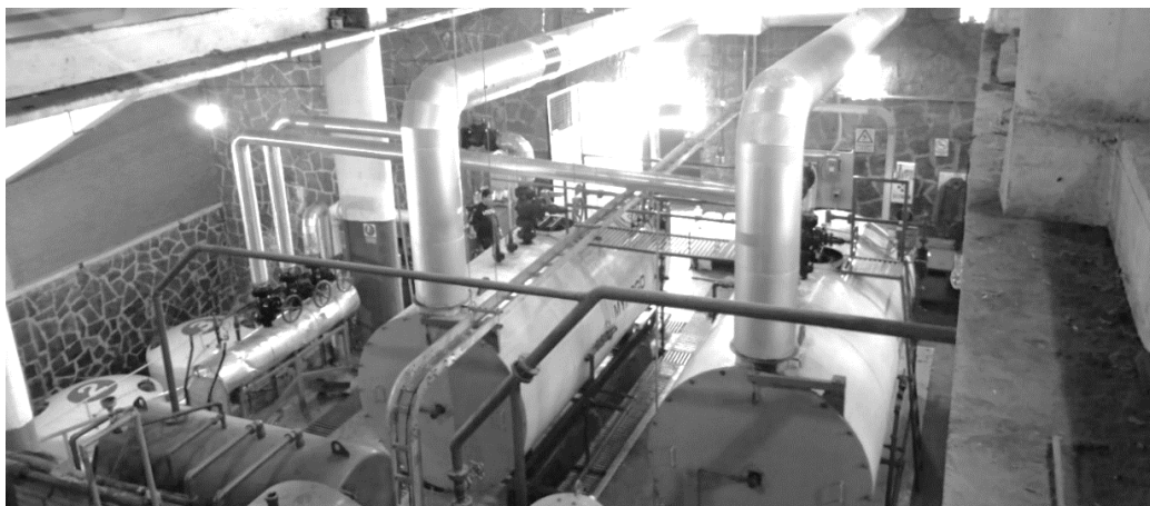
Fotografía 2 Cuarto de máquinas, caldera 1 y 2.
