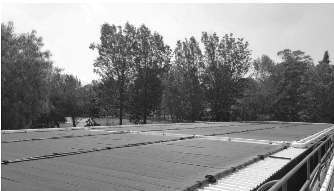
Fotografía 3 Colectores solares, pasillo sur.
