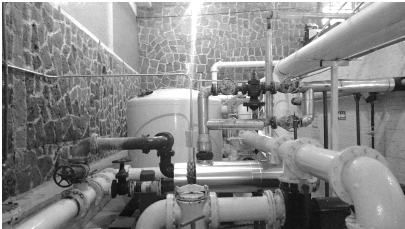
Fotografía 5 Cuarto de máquinas, intercambiador de calor.
