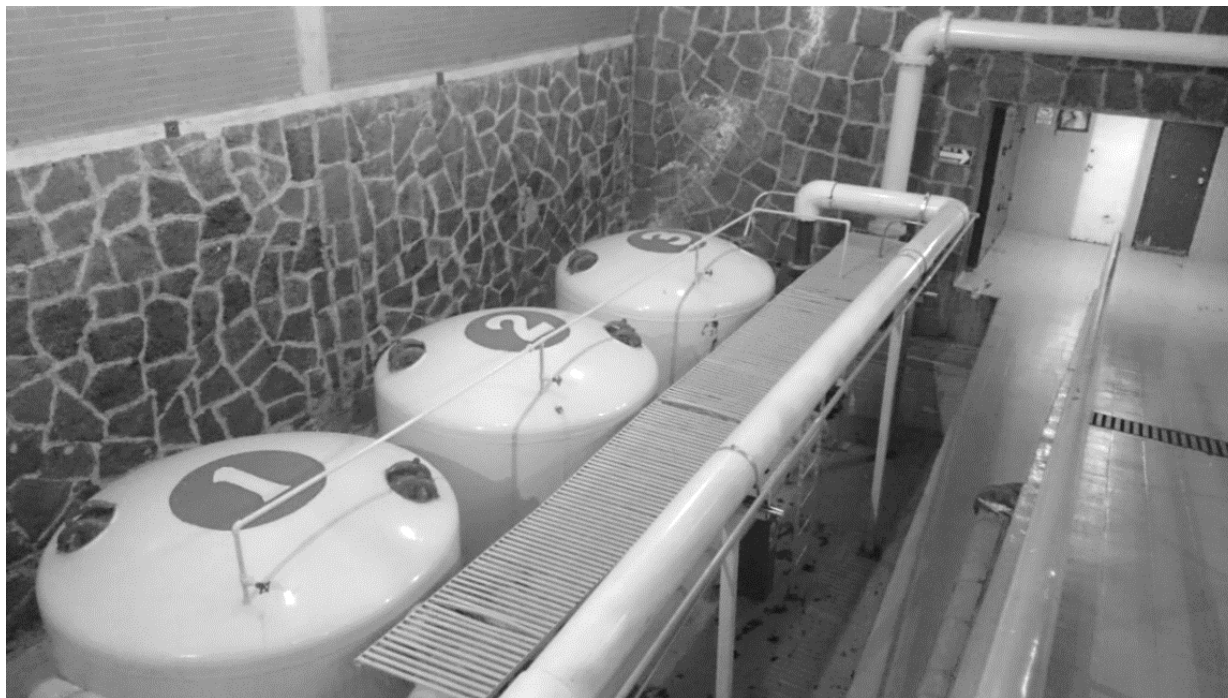
Fotografía 4 Cuarto de máquinas filtrado mayor.
