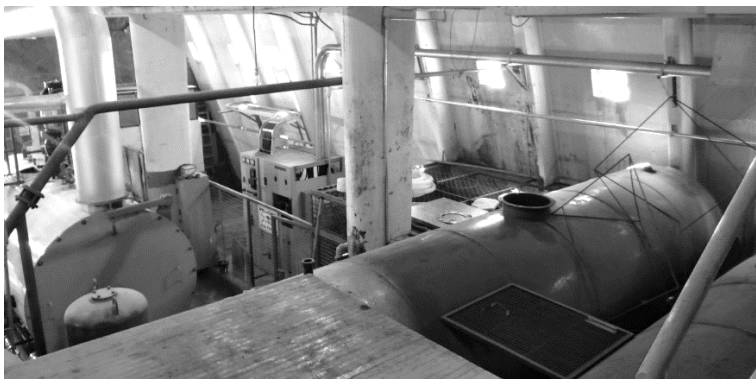
Fotografía 6 Tanques de Diésel y control eléctrico.
