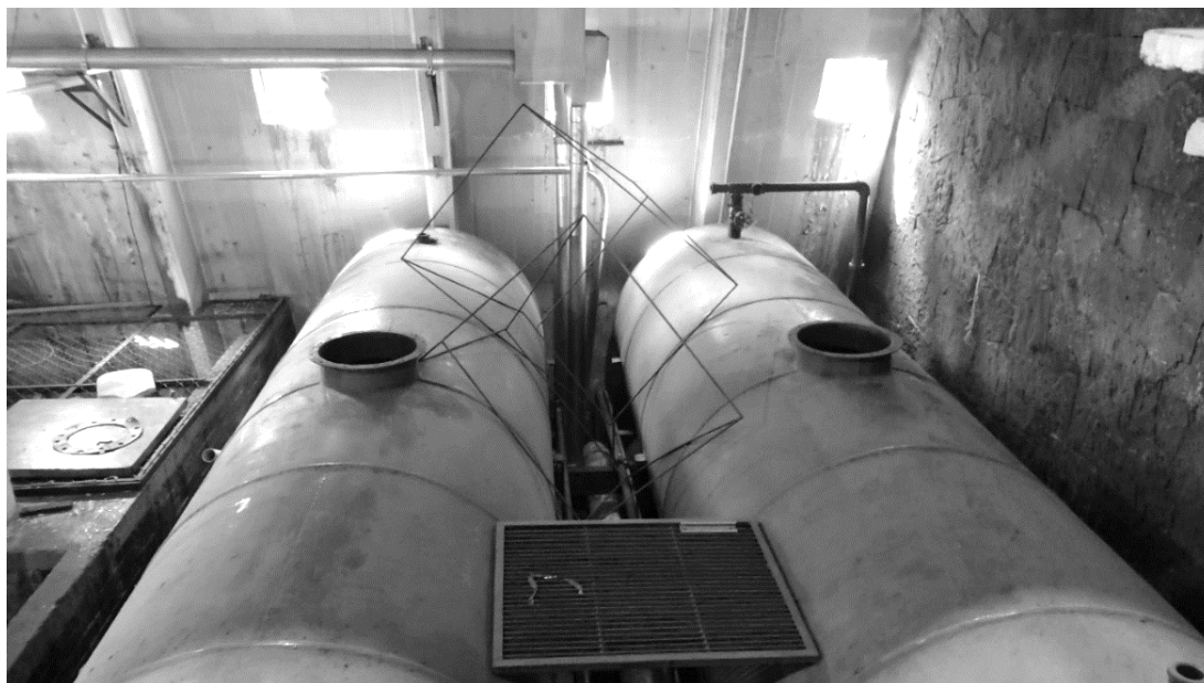
Fotografía 9 Tanques de Diesel.
