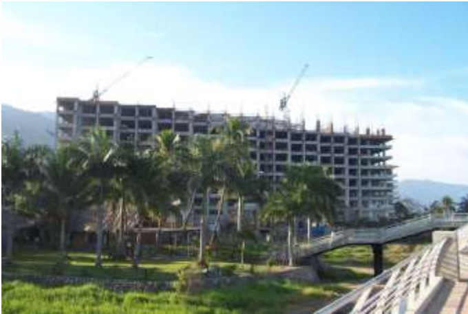
Ilustración 74 Edificio de condominios establecido al margen del río Cuale en la zona centro de la ciudad. Referencia: dominio público.
