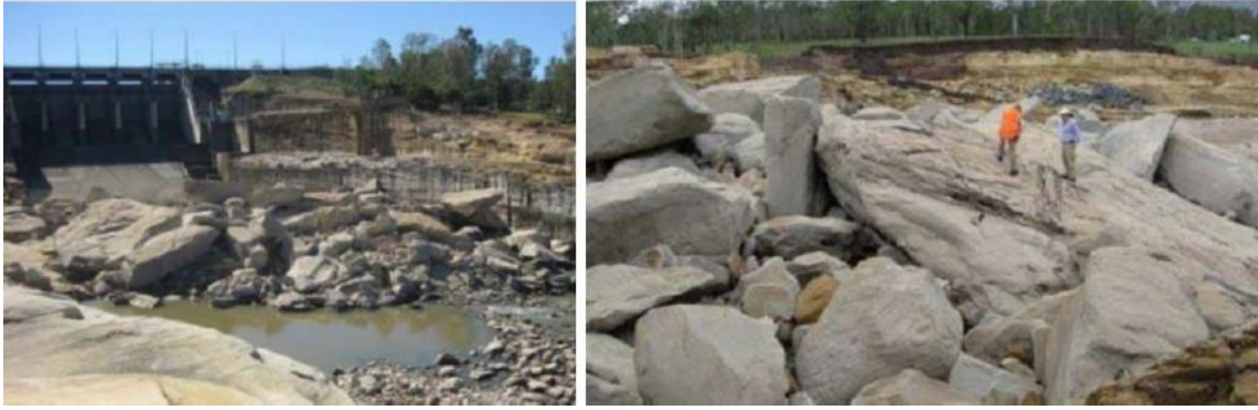
Figura 8.5. Presa Wivenhoe, Australia. Desprendimiento y arrastre de grandes bloques de roca del tanque de amortiguación labrado en el macizo rocoso de cimentación (Stratford et al., 2013).
