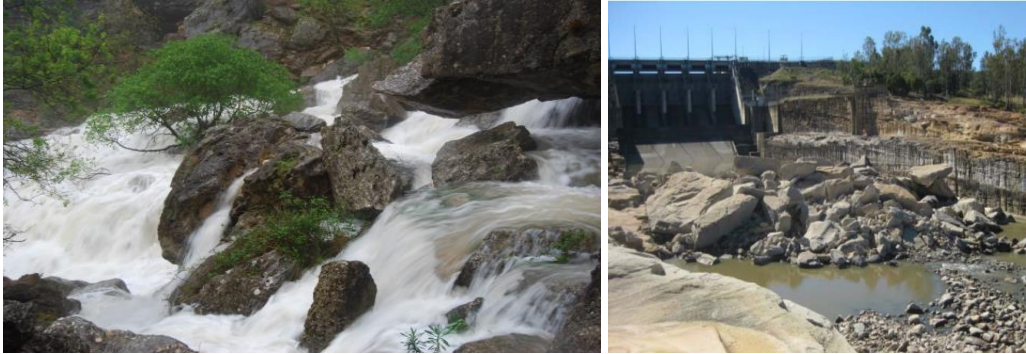
Figura 5.10. Socavación en lechos rocosos de ríos de montaña (alta pendiente) y en estanques amortiguadores de presas labrados directamente en el macizo rocoso. (Bollaert y Lesleighter, 2014)
