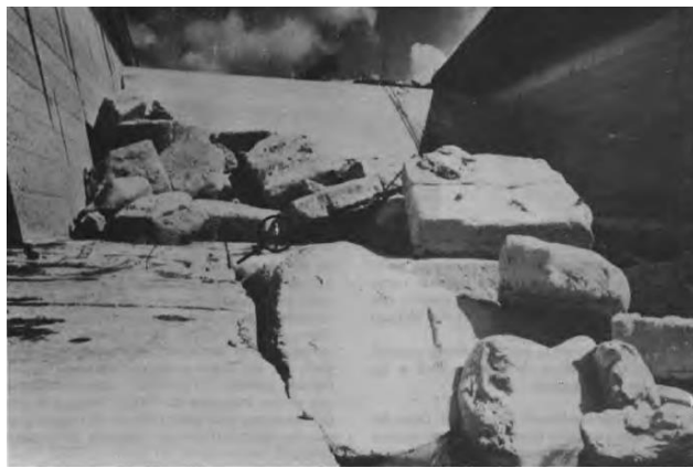
Figura 8.6. Presa Nezahualcóyotl (Malpaso), Chiapas, México. Losas del estanque amortiguador desplazadas hacia aguas abajo (Marsal y Reséndiz, 1975).
