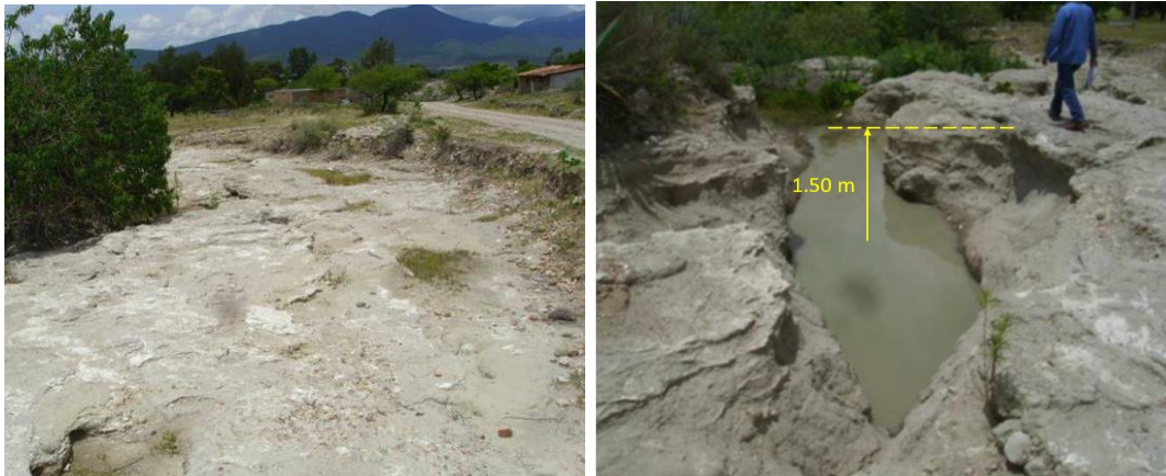
Figura 9.16. Socavación en el lecho del canal vertedor de la presa.
