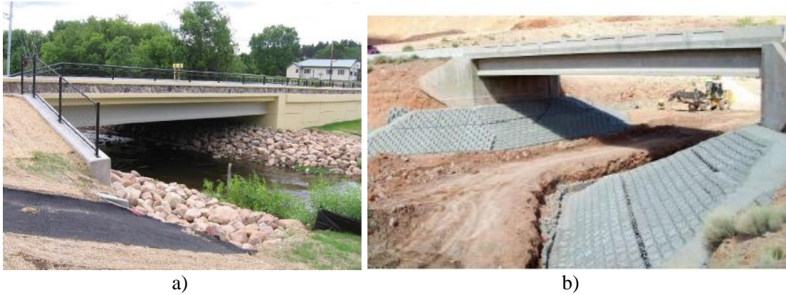
Figura 7.45. Protección de estribos en puentes mediante (IHRB, 2006): (a) enrocamiento y (b) pavimentos flexibles.
