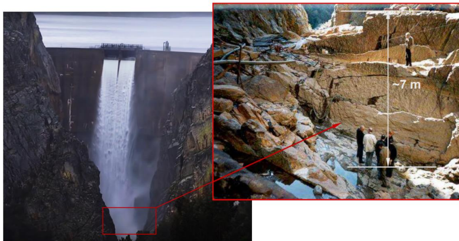
Figura 8.7. Presa Santa Luzia, Coimbra District, Portugal. Desprendimiento de bloques de roca en estanque de amortiguación (labrado en el macizo rocoso) (modificada de Annadale, 2006).
