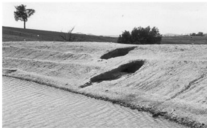
Figura 8.42. Tubificación en una presa construida con suelos dispersivos en NWS, Australia (Fell et al., 2015).
