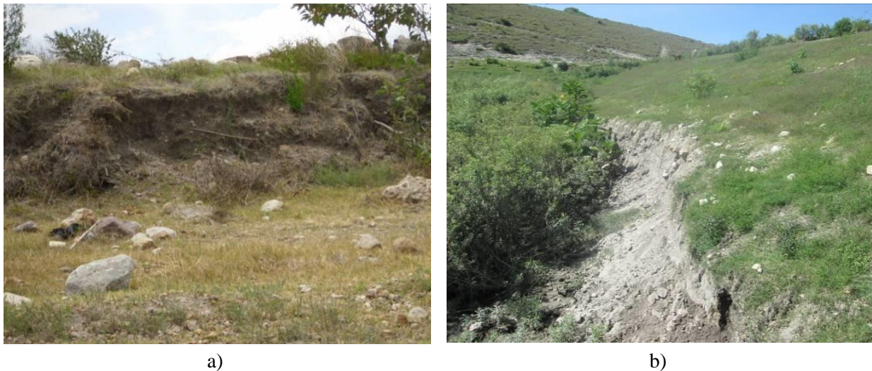
Figura 9.22. Socavación por oleaje en (a) la parte alta y (b) parte baja del talud aguas arriba de la presa.
