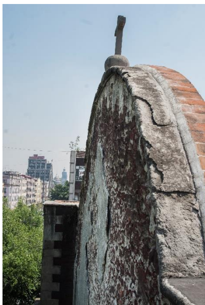
Fig. 222 Desprendimiento del aplanado del ábside (fotografía: Brian Nolasco, 2018).
