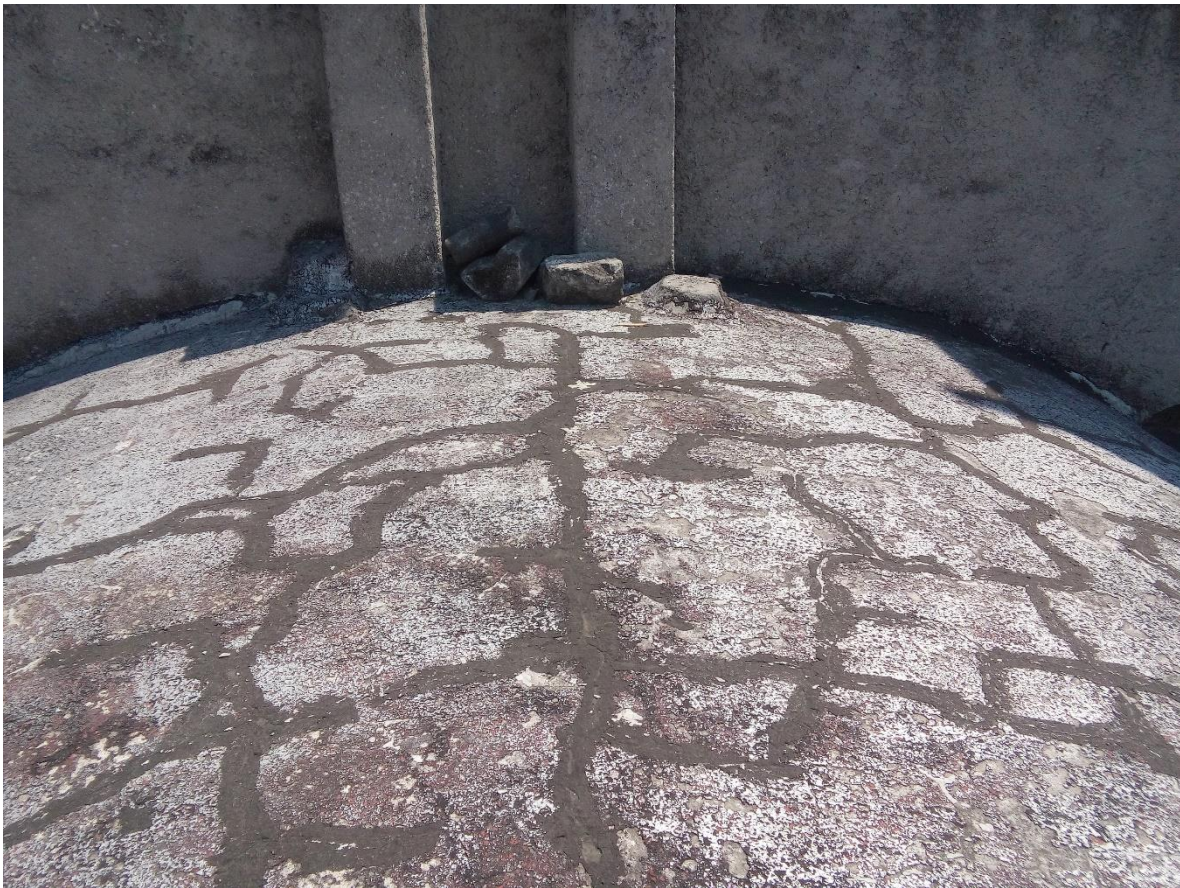
Figura 8. Detalle del impermeabilizante con chapopote en la bóveda del templo (fotografía: Leticia Domínguez, 2018).
