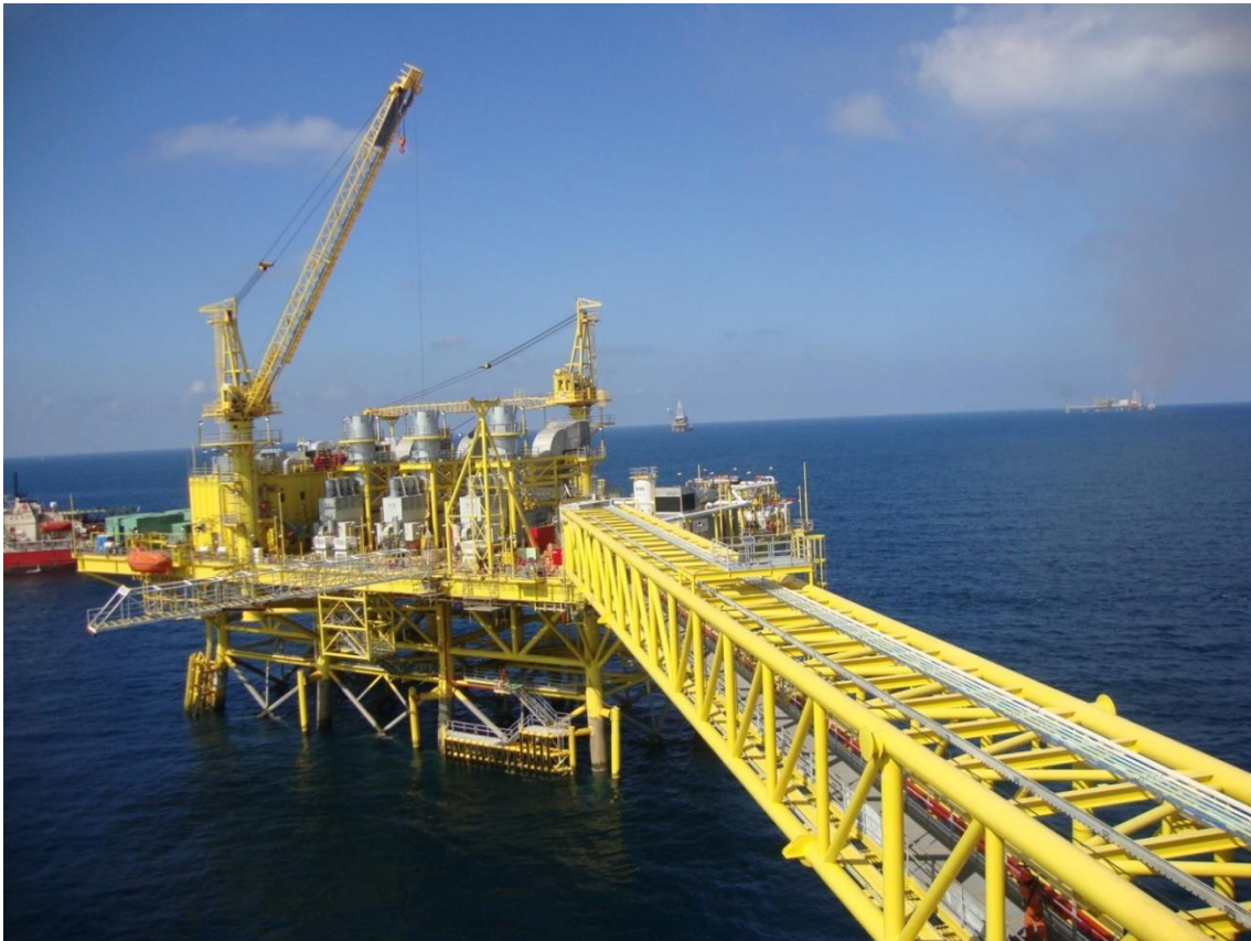
Figura 3.26 Componentes en una plataforma de generación eléctrica (Pemex Exploración y Producción, 2013)
