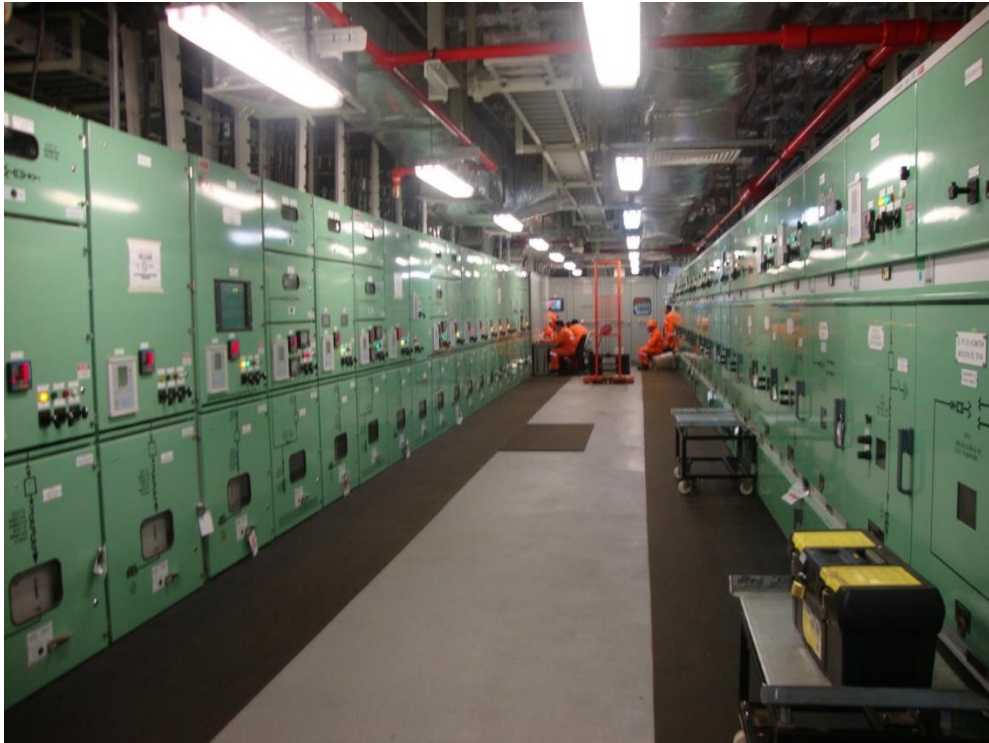
Figura 3.28 Tablero de media tensión (Pemex Exploración y Producción, 2014)
