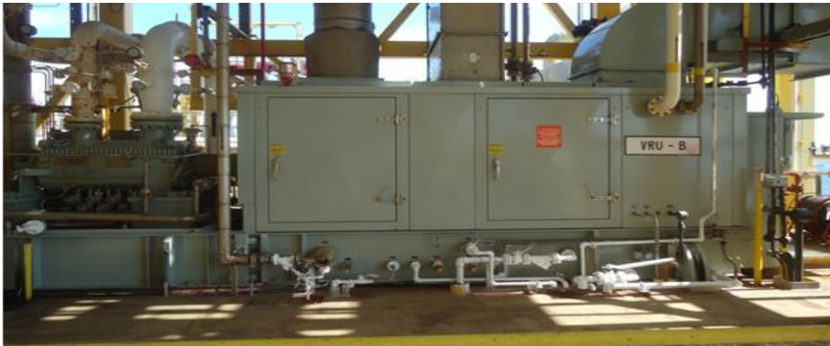
Figura 3.19 Imagen representativa de una recuperadora de vapores (Pemex Exploración y producción, 2014)
