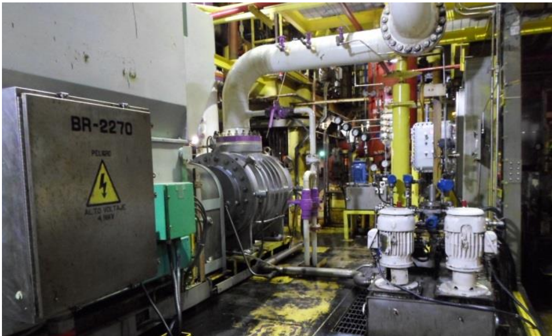
Figura 3.14 Imagen representativa de una electrobomba instalada en una plataforma de producción (Pemex Exploración y Producción, 2014)
