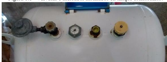
Figura 1.8 - Válvulas e indicador instalados en tanque estacionario.
