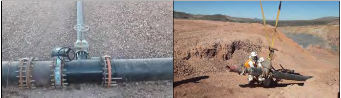
Figura 3.9 Válvulas en los disparos.
