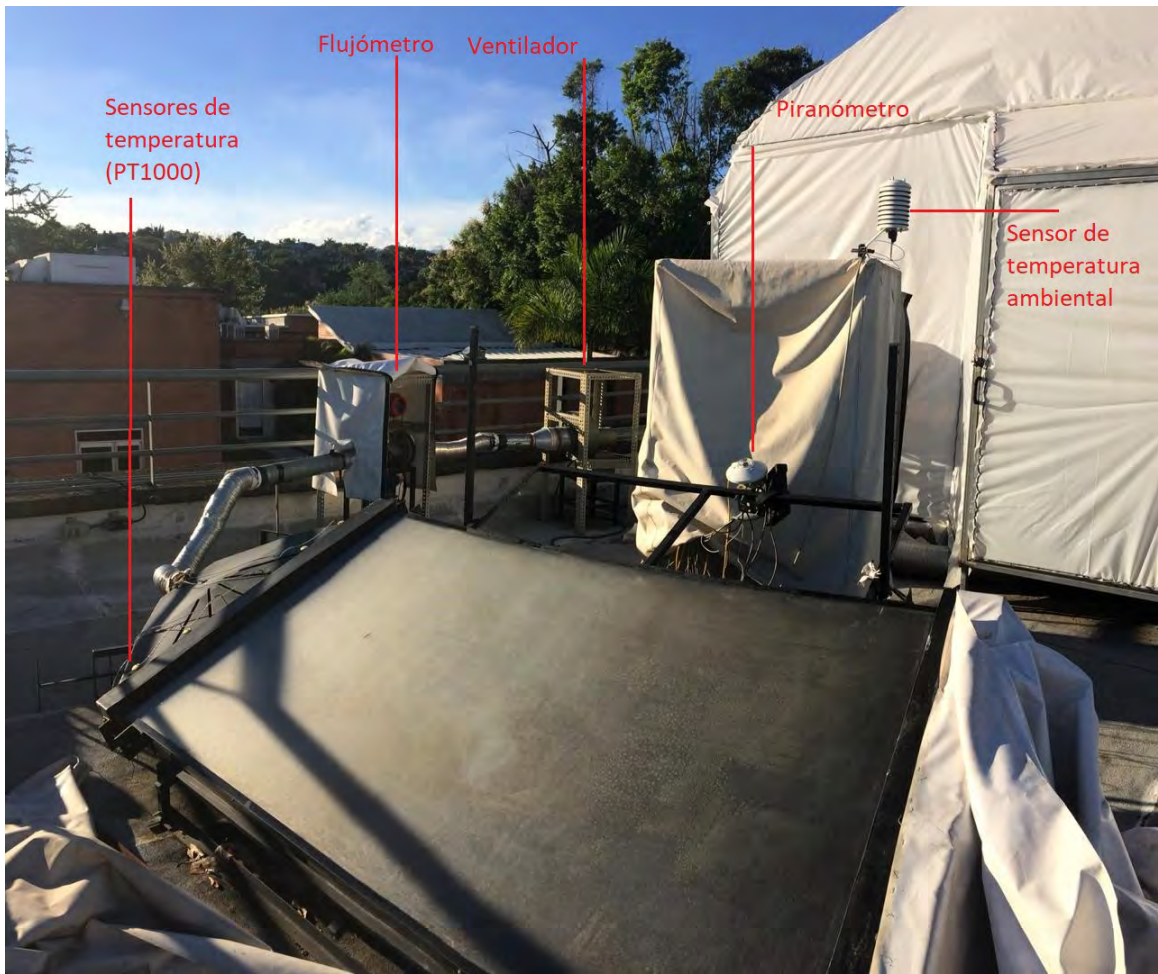
Figura 3.9: Banco experimental de pruebas de rendimiento térmico
