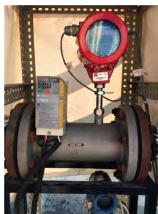
Figura 3.4: Variador de frecuencia y flujómetro utilizado en las pruebas
