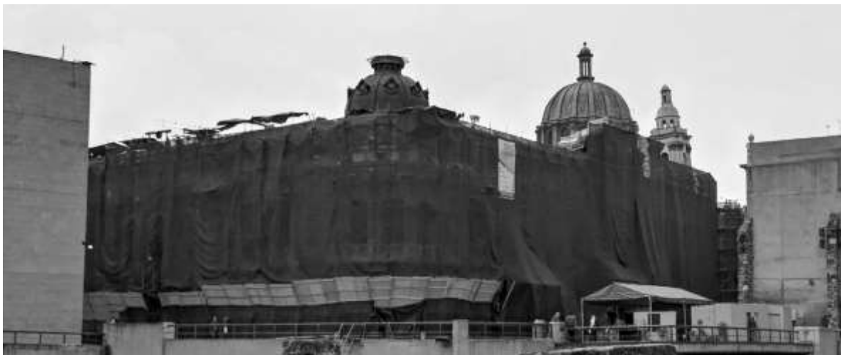
Trabajos de Restauración y Conservación Preventiva a Palacio de la Autonomía, UNAM, del 1 de Agosto al 30 de Noviembre del 2018
