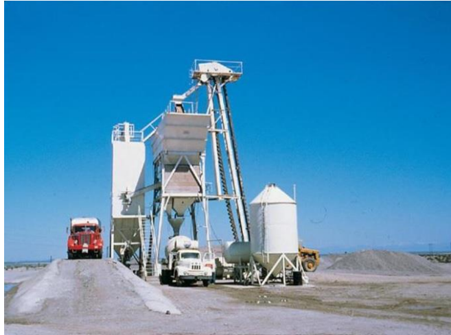
Imagen 5-9. Planta dosificadora de concreto. 56
