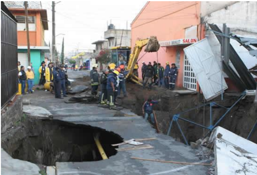
Socavón causa de un agrietamiento.
