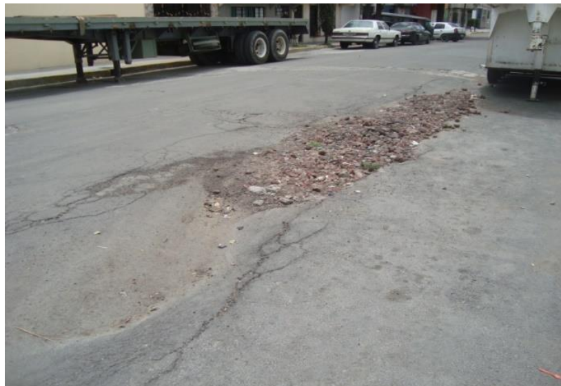
Se pueden observar pequeñas socavaciones, vecinos del lugar se encargan de rellenarlos cuando estos aparecen.
