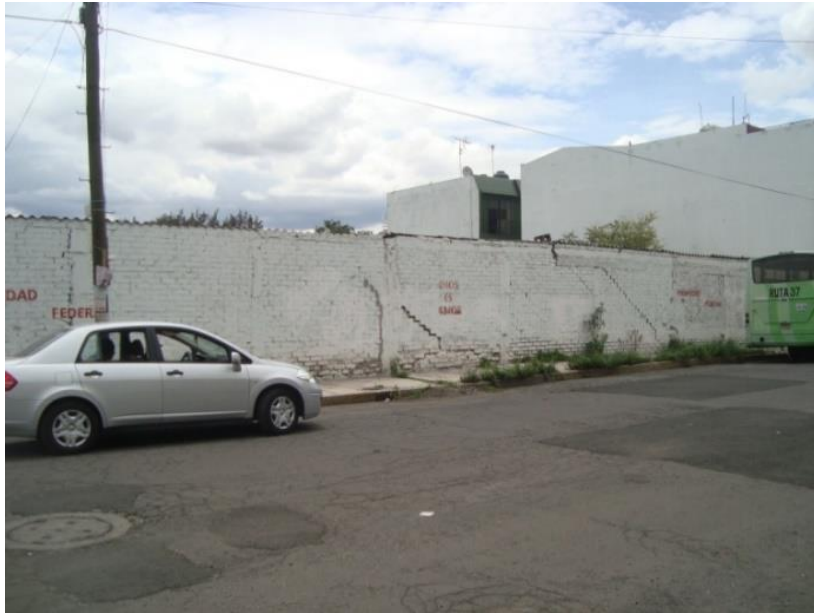
Actualmente manzanas enteras son Propiedad Federal debido al alto riesgo
