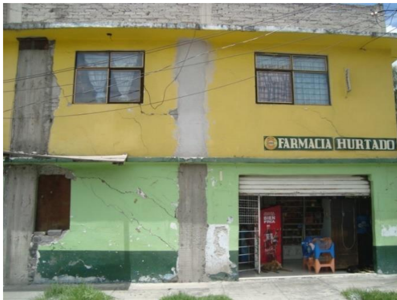
Esta vivienda ubicada en Filomeno Mata, construyo castillos como medida de mitigación sin embargo no dio resultado.
